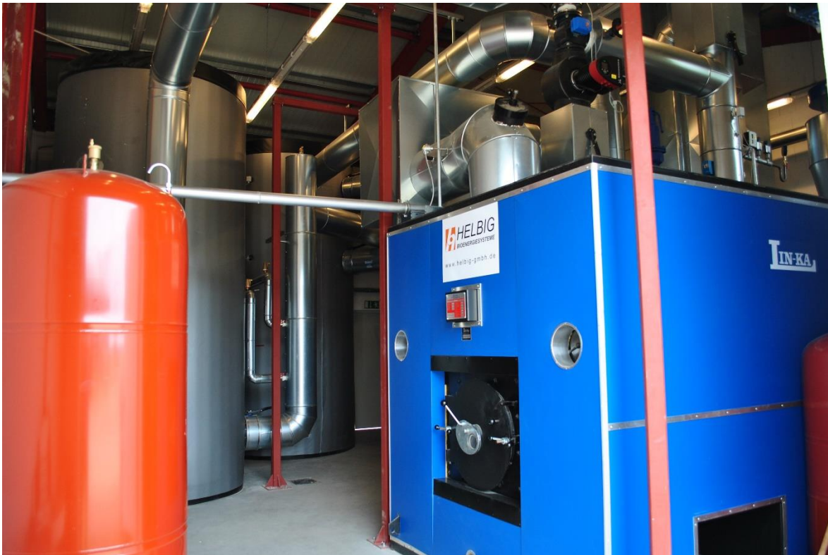
Abbildung 34: Strohheizung Güstrow mit 1.000 kW th Leistung - Demonstrationsanlage der LGMV, seit 2013 in Betrieb (Quelle: LGMV)
