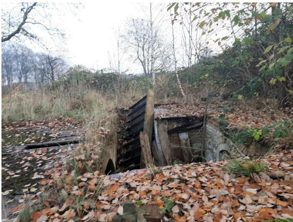
Abb. 4: Ruine mit Keller im Südwesten des Plangebietes, eigene Aufnahme.
