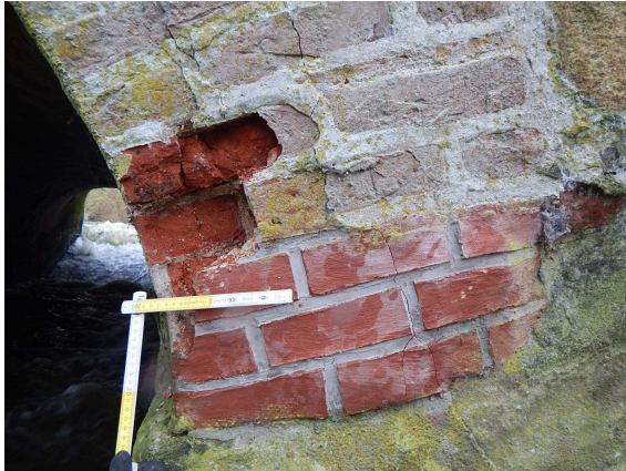
2131505_0_2020H_L-BOGENSTIRNSEITE VORNE MW BRÜCHIG
