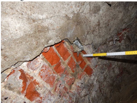
2131505_0_2020H_GEWÖLBE HINTEN RECHTS ZIEGEL BRÜCHIG
