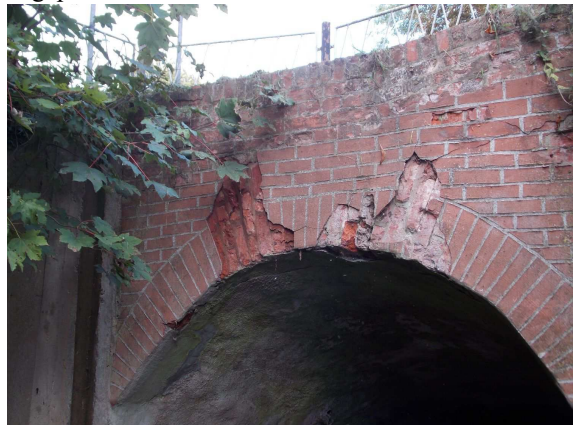
2131505_0_2013E_RECHTER GEWÖLBEBOGEN INSTANDSETZUNG ABGEPLATZT
