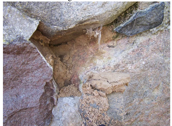
2131505_0_2009H_L-STW HINTEN MÖRTEL SANDIG
