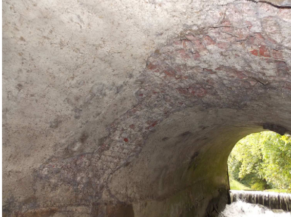
2131505_0_2013E_GEWÖLBE MITTE SPRITZBETON ABGEPLATZT
