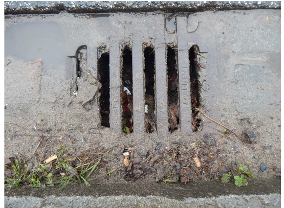
2131505_0_2020H_R-ABLAUF VORNE VERSCHMUTZT
