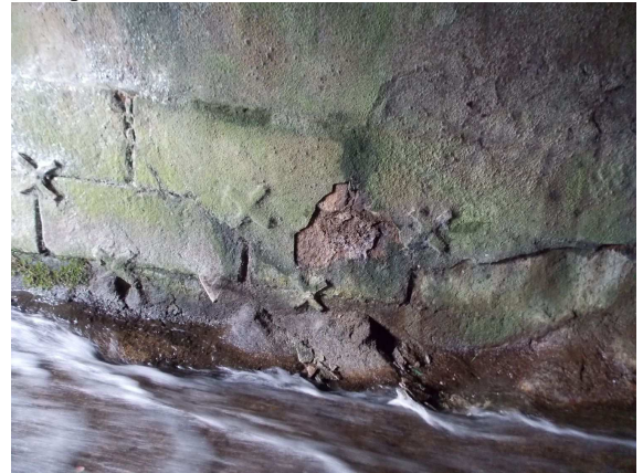
2131505_0_E13_KÄMPFER 1 RECHTS SPR-BETON ABGEPLATZT
