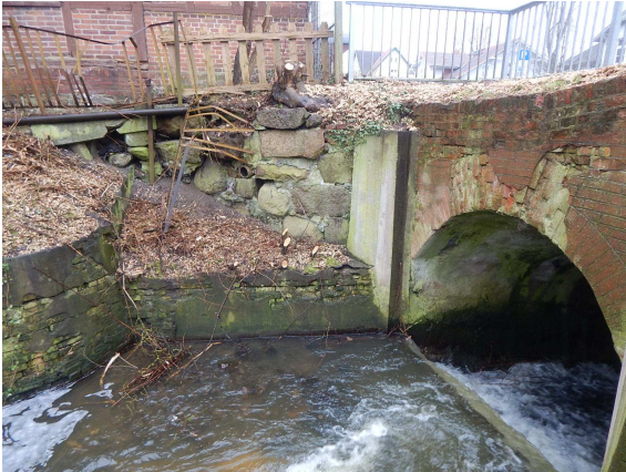
2131505_0_2020H_R-FL WL-V MAUERWERK BRÜCHIG
