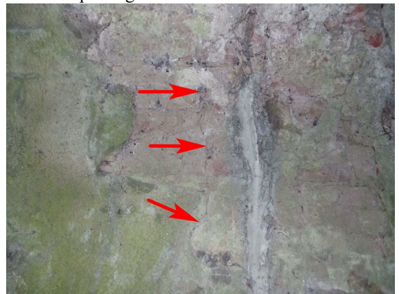
2131505_0_2013E_GEWÖLBE HINTEN LINKS GERISSEN
