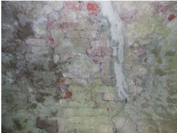
2131505_0_2013E_GEWÖLBE VORNE LINKS GERISSEN
