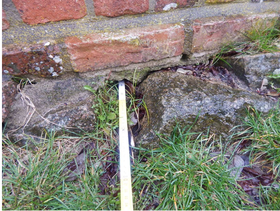
2131505_0_2020H_L-BRÜSTUNG MITTIG RECHTS UNTEN A-FUGE HERAUSGEBROCHEN
