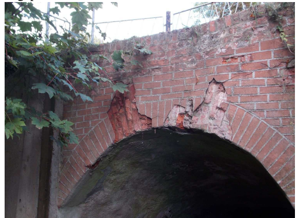
2131505_0_2013E_RECHTER GEWÖLBEBOGEN INSTANDSETZUNG ABGEPLATZT
