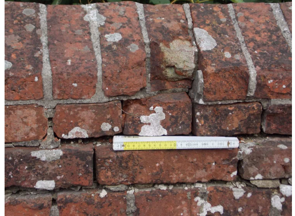
2131505_0_2013E_L-BERÜSTUNG HINTEN ABDECKUNG BRÜCHIG
