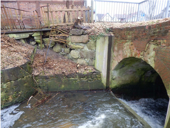
2131505_0_2020H_R-FL WL-V MAUERWERK BRÜCHIG
