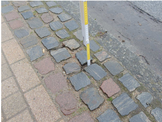
2131505_0_2020H_L-WEG HINTEN FUGEN AUSGESPÜLT
