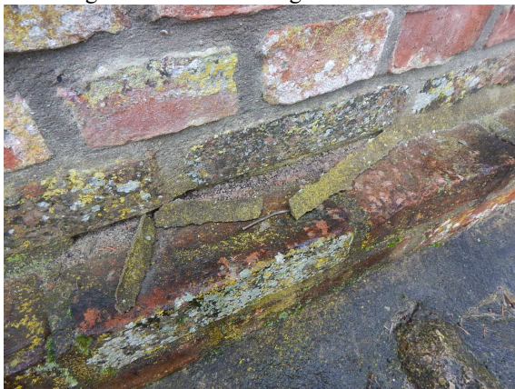
2131505_0_2020H_L-BRÜSTUNG HINTEN LINKS UNTEN FUGE BRÜCHIG
