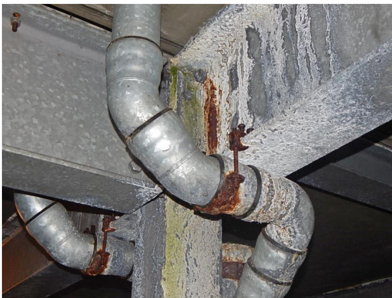
Befestigung der Fallrohre korrodiert
