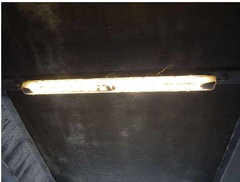
Abbildung 20, verschmutzte/defekte Beleuchtungen des unteren Parkdecks
