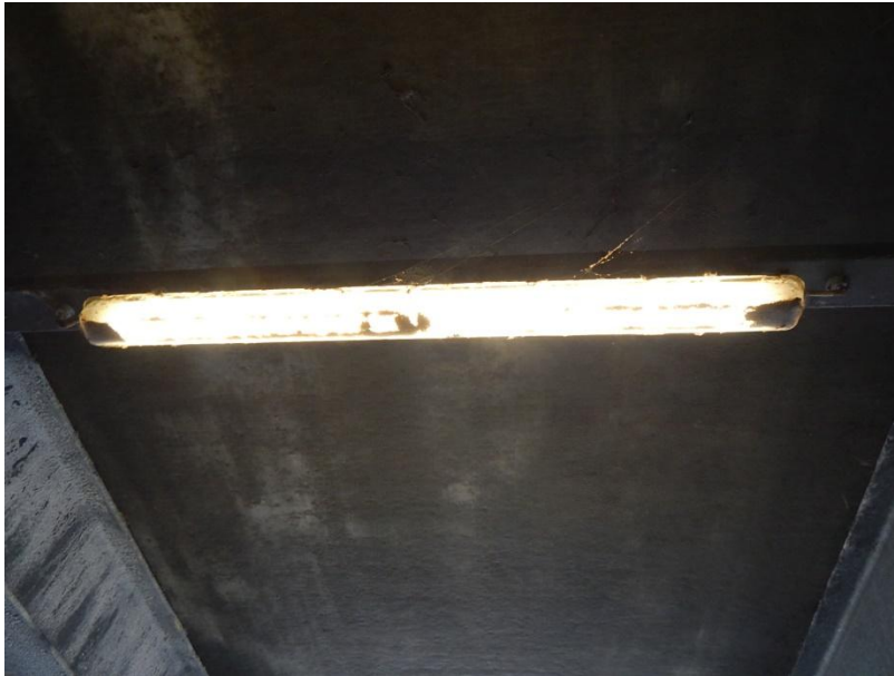
Verschmutzte/defekte Beleuchtungen des unteren Parkdecks
