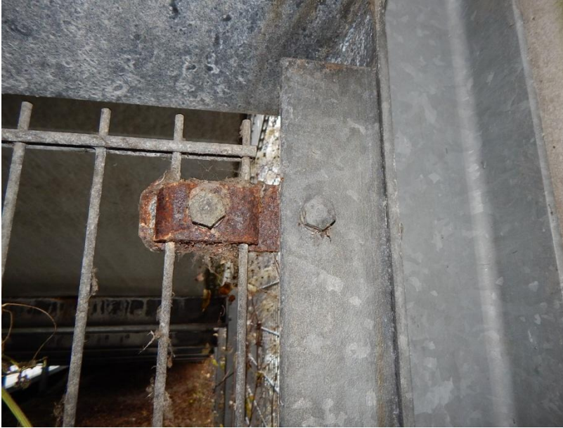
Gitterfüllungen, verrostete Verbindungsmittel
