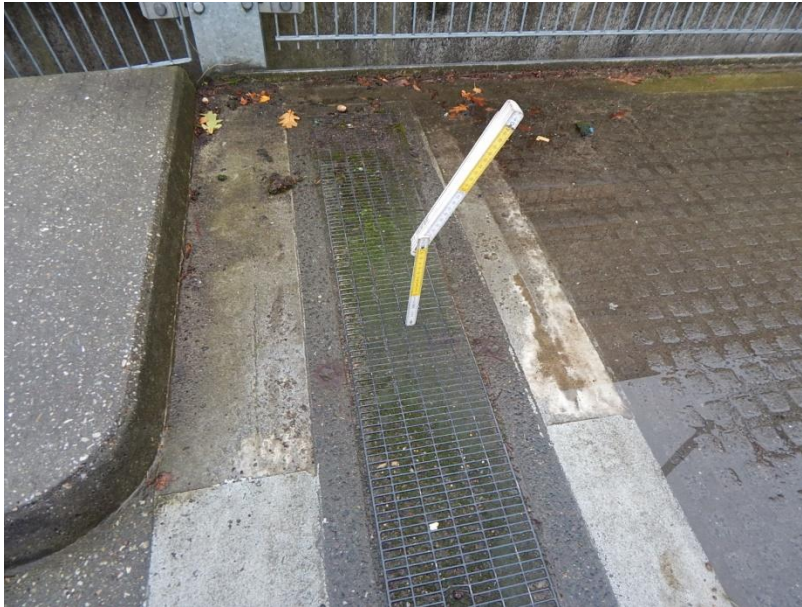
Verstopfte Entwässerungsrinne am oberen Rampenpunkt
