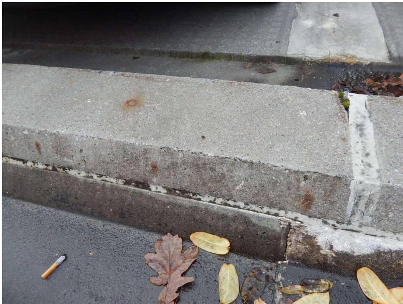
Abbildung 18, schadhafter Schrammbord, Rost und Kantenabbruch
