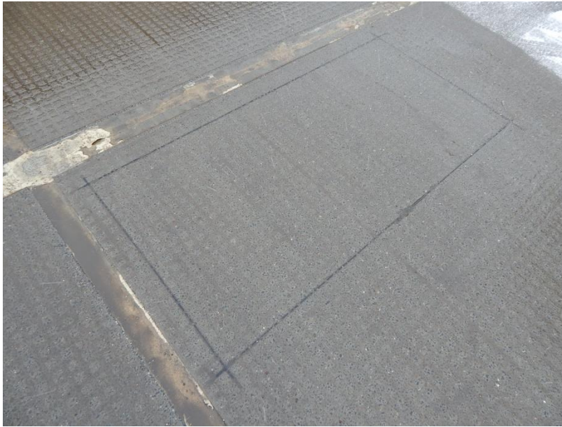
Oberes Parkdeck, Ausfräsung für Induktionsschleife der Ampelanlage; Verguss defekt
