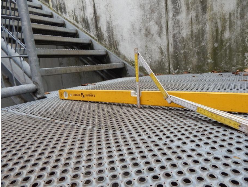
Treppenanlage, durchgebogene Beläge
