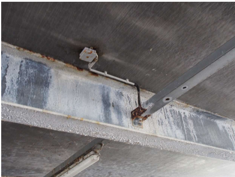
Abbildung 24, Unterseite Betondecke mit Anschlussdose für Induktionsschleife, dort Wasseraustritt
