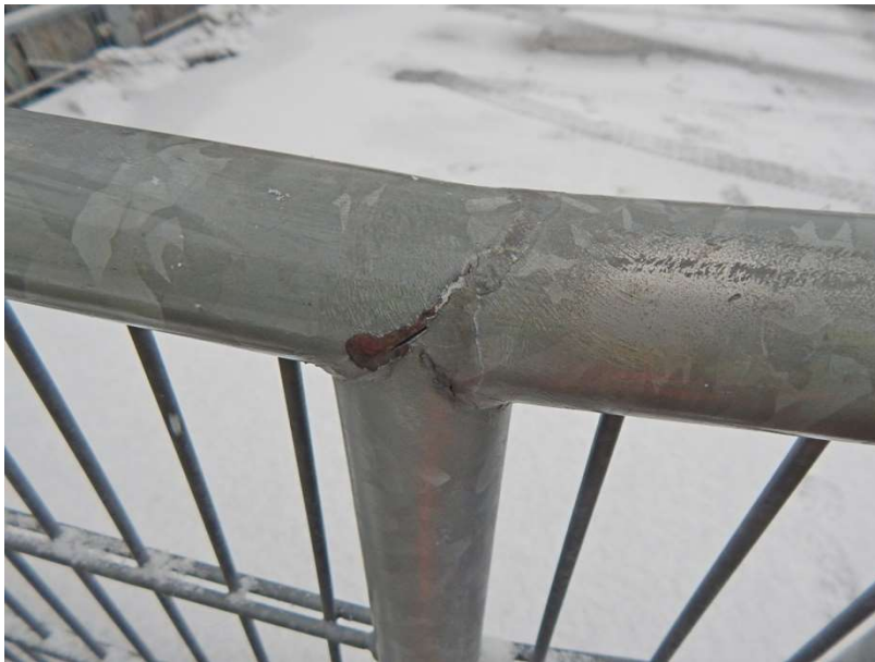
Abbildung 30, Geländer, gerissene Schweißnaht
