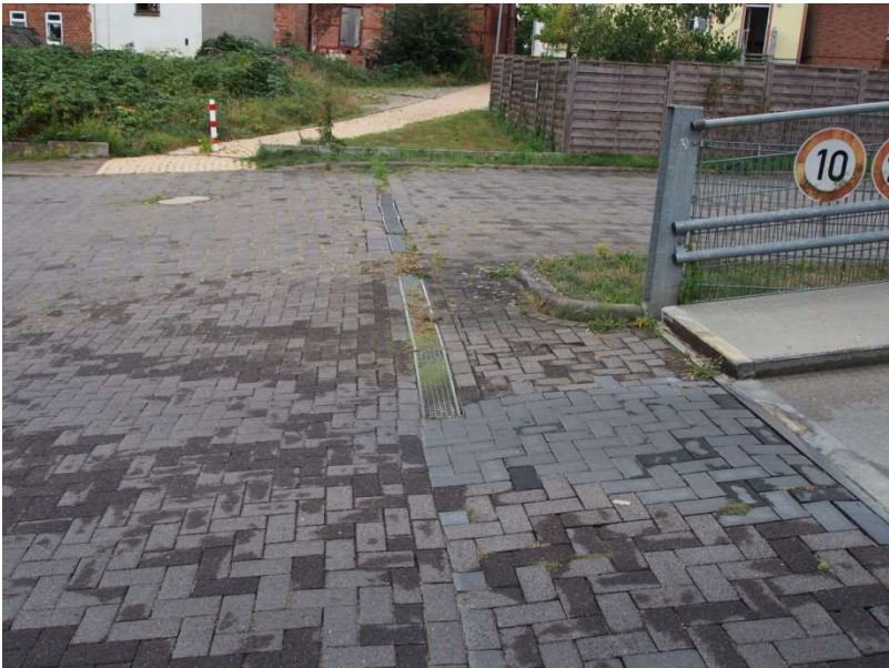
Abbildung 14, Fußpunkt der Rampe, Entwässerungsrinne defekt und verstopft
