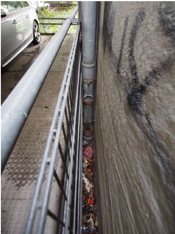
Abbildung 13, Fallrohr, Revisionsöffnung nicht zugänglich
