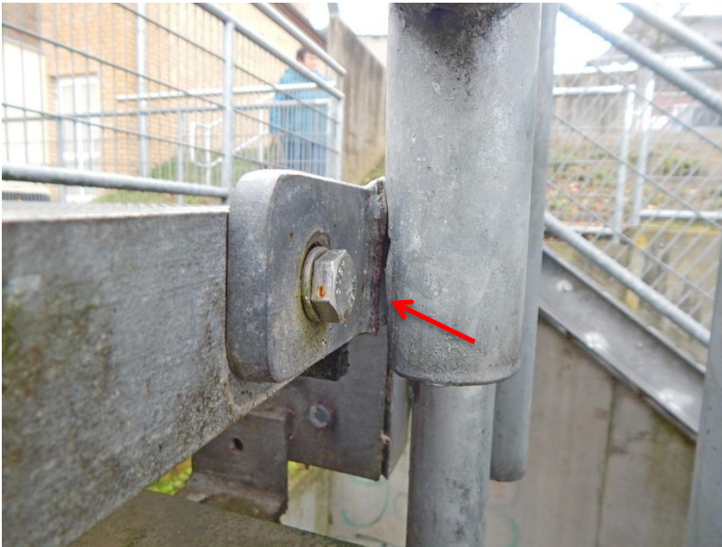
Geländer, Pfosten abgerissen
