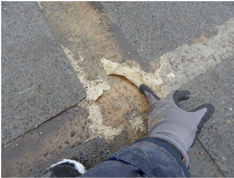
Abbildung 6, defekte Vergussfugen der Deckenplatten
