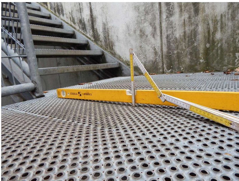
Abbildung 35, Treppenanlage, durchgebogene Beläge
