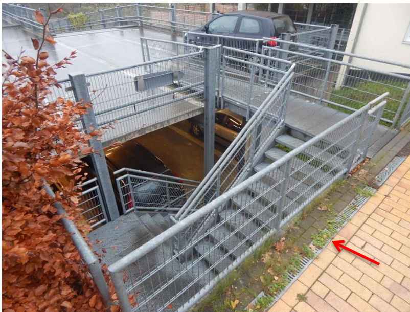
Entwässerungsrinne am Treppenturm verstopft und defekt
