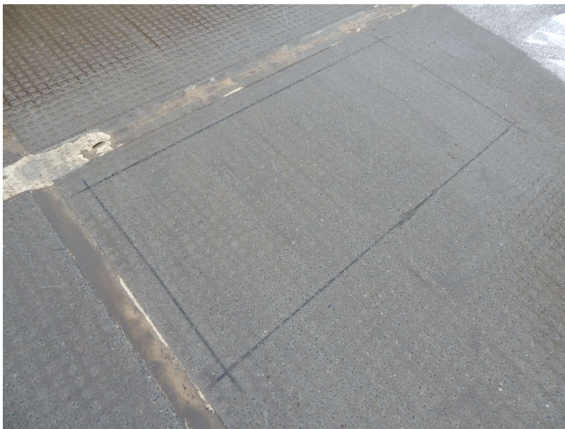
Abbildung 22, oberes Parkdeck, Ausfräsung für Induktionsschleife der Ampelanlage; Verguss defekt
