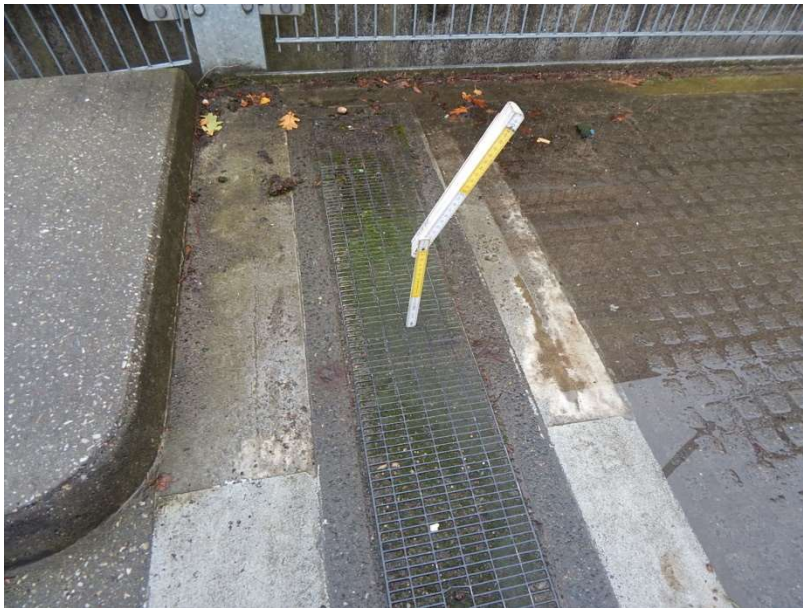
Abbildung 15, verstopfte Entwässerungsrinne am oberen Rampenpunkt
