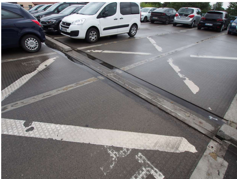
Abbildung 28, oberes Parkdeck, Markierungen verschlissen
