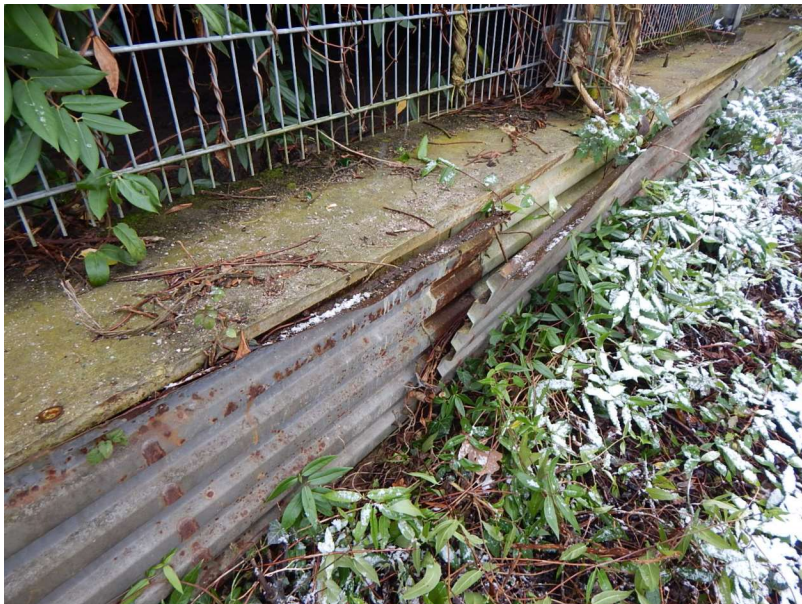
Abbildung 37, Schalungsreste am Fundament
