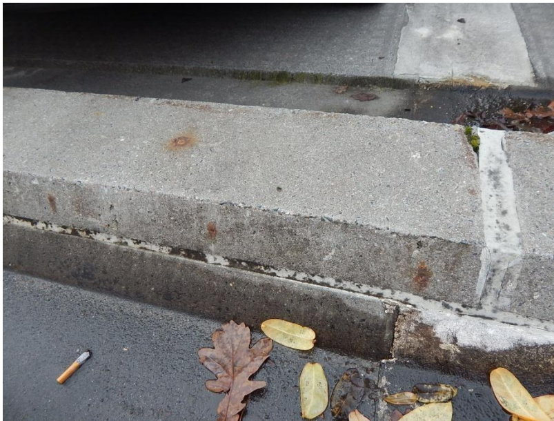
Schadhafter Schrammbord, Rost und Kantenabbruch
