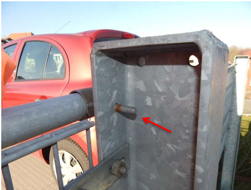
Abbildung 34, Geländer, fehlende Verbindungsmittel
