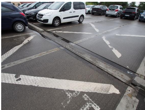
Oberes Parkdeck, Markierungen verschlissen
