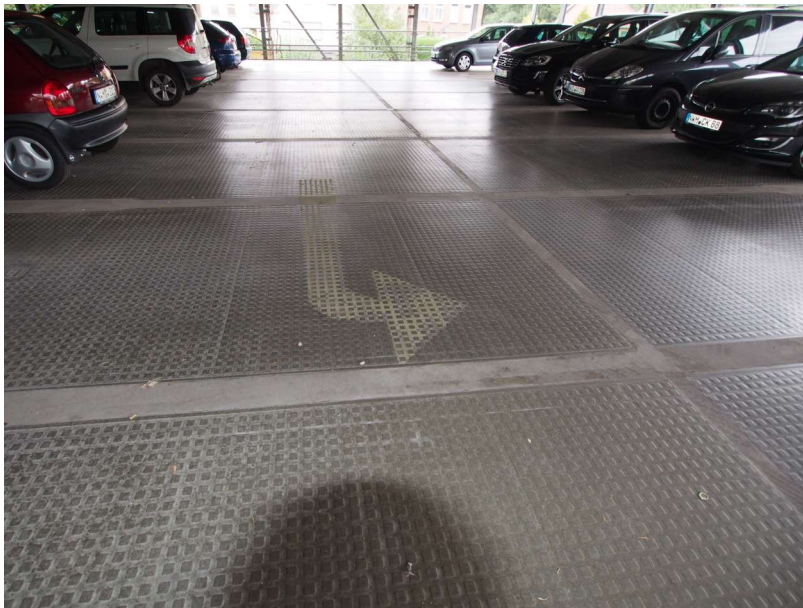
Abbildung 29, unteres Parkdeck, Markierungen verschlissen
