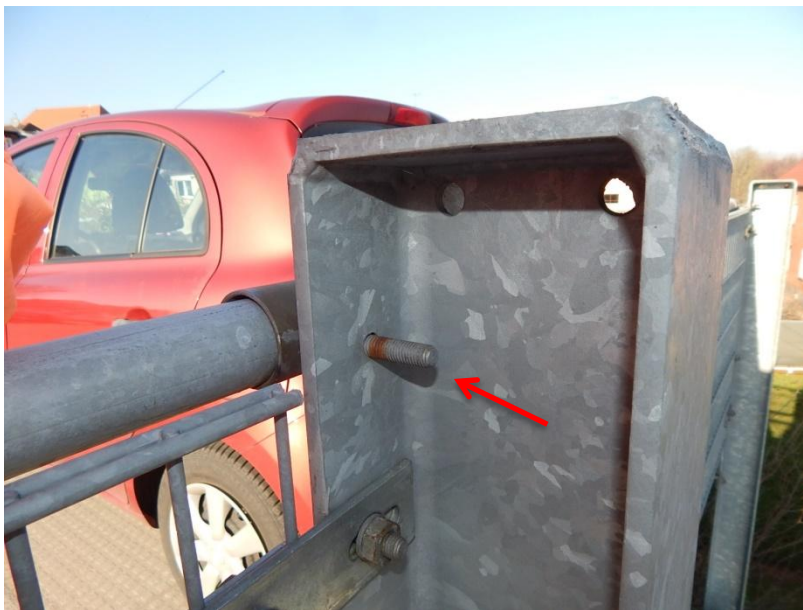
Geländer, fehlende Verbindungsmittel
