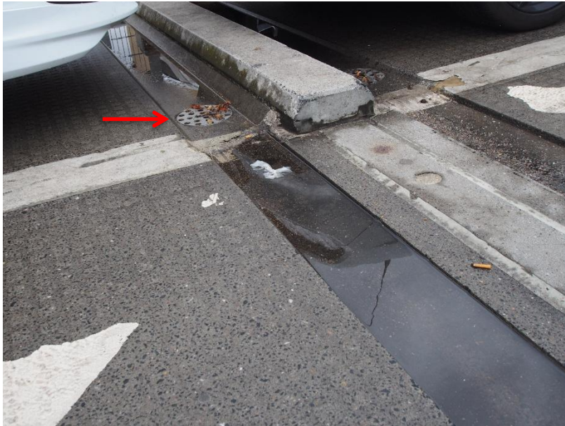
Deckenentwässerung, alle Abläufe nicht im Rinnentiefpunkt
