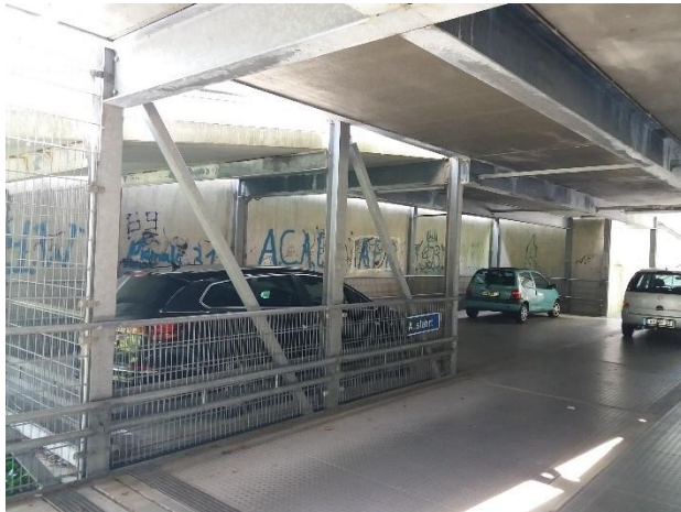
Stützwand Südseite (Innenansicht), Graffiti
