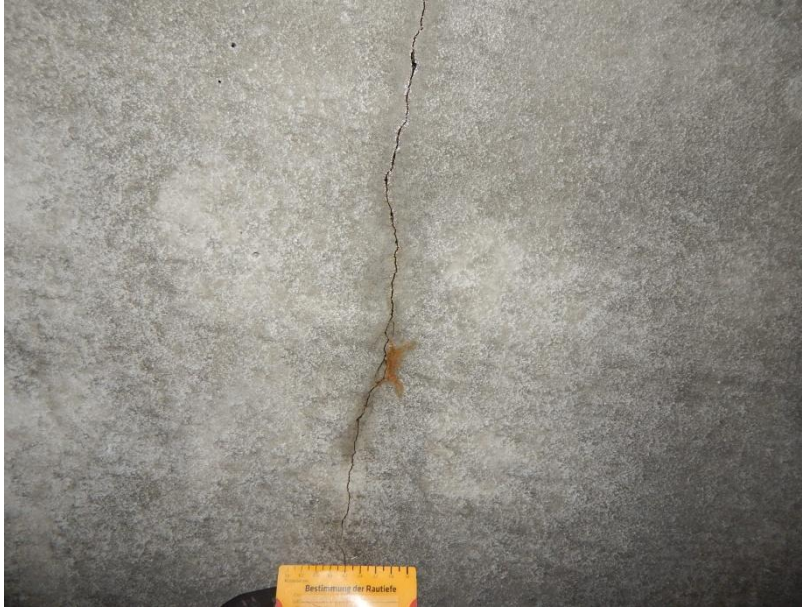
Unterseite Deckenplatten, lokale Querrisse
