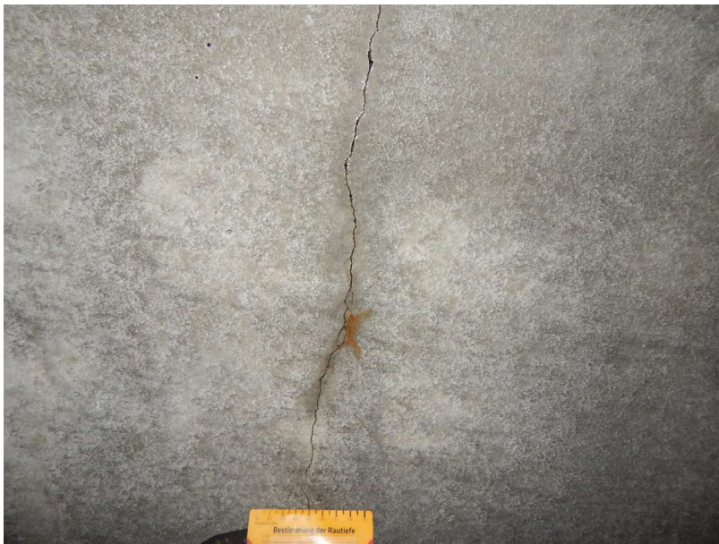
Abbildung 7, Unterseite Deckenplatten, lokale Querrisse
