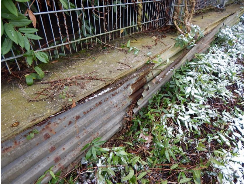
Schalungsreste am Fundament, nur an der Nordseite
