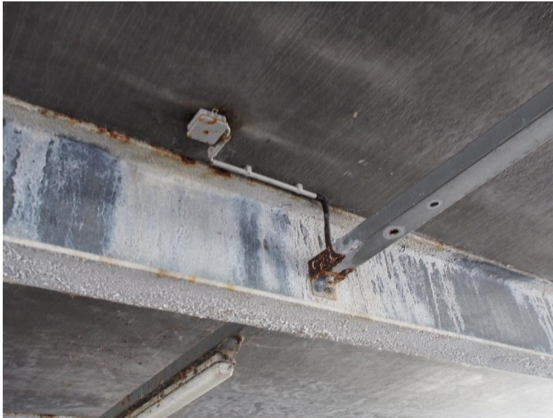
Unterseite Betondecke mit Anschlussdose für Induktionsschleife, dort Wasseraustritt
