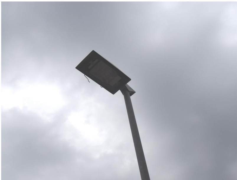
Beleuchtung oberes Parkdeck
