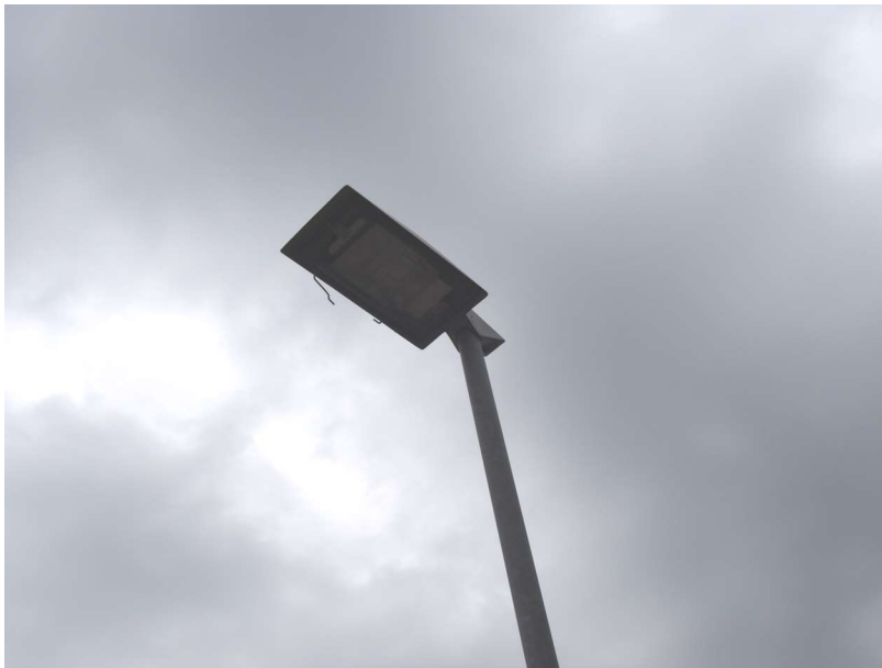
Abbildung 23, Beleuchtung oberes Parkdeck
