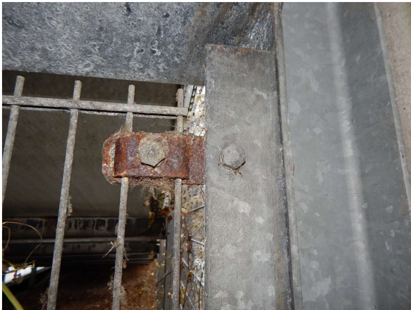
Abbildung 31, Gitterfüllungen, verrostete Verbindungsmittel
