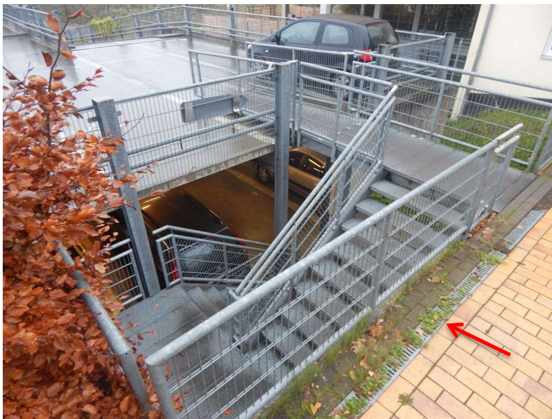
Abbildung 16, Entwässerungsrinne am Treppenturm verstopft und defekt
