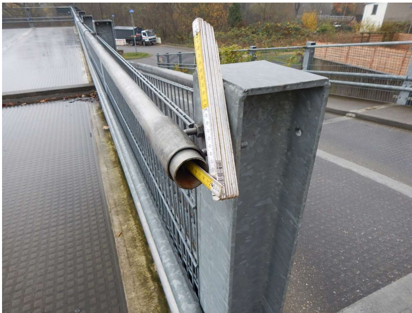
Abbildung 33, Geländer, offene Enden von Handläufen
