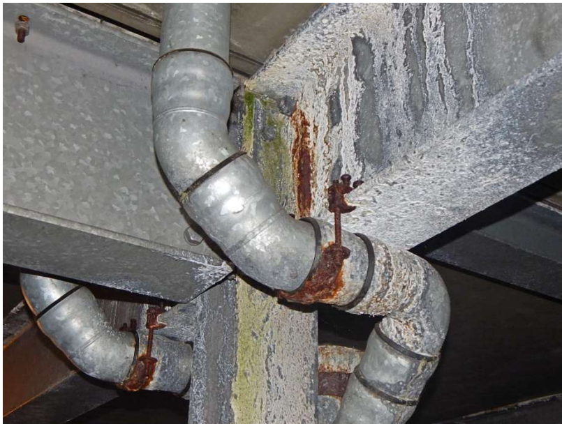
Abbildung 11, Befestigung der Fallrohre korrodiert
