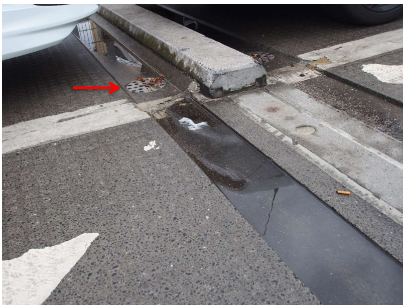
Abbildung 10, Deckenentwässerung, alle Abläufe nicht im Rinnentiefpunkt
