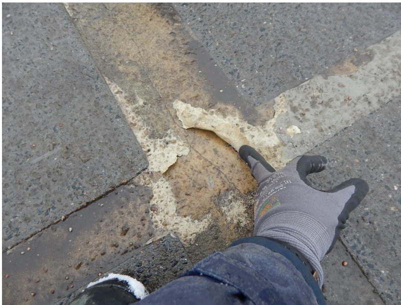
Defekte Vergussfugen der Deckenplatten
