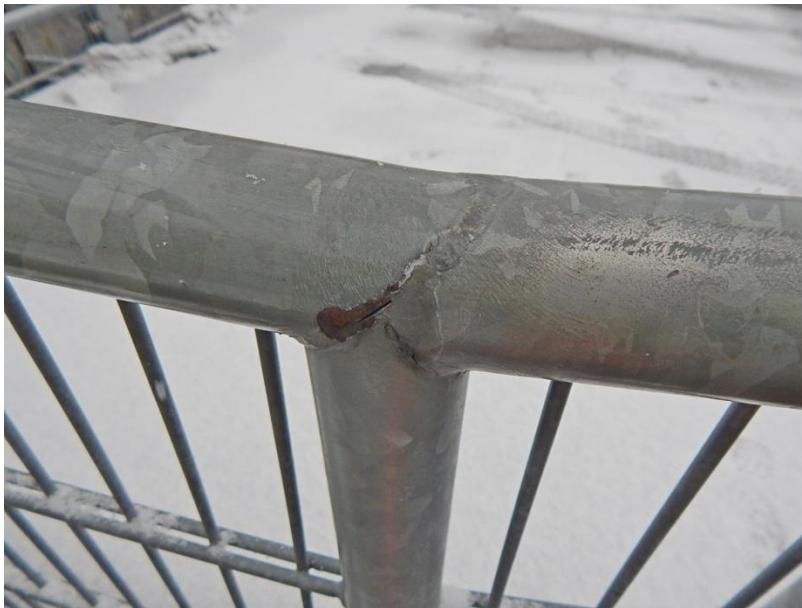
Geländer, gerissene Schweißnaht
