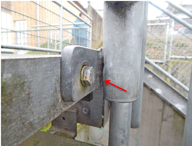
Abbildung 32, Geländer, Pfosten abgerissen
