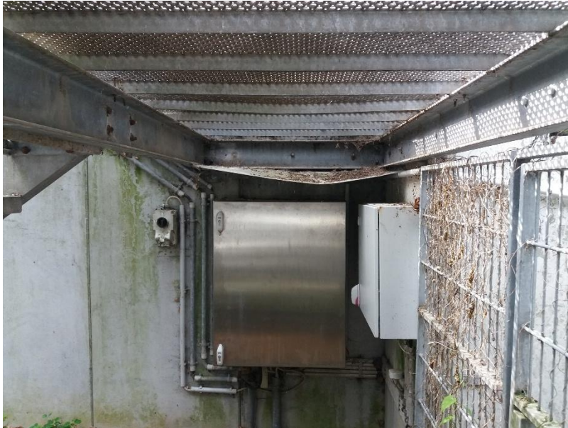
Schaltkasten mit Abdeckung
