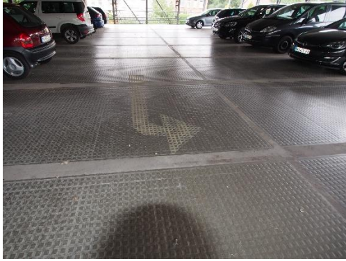
Unteres Parkdeck, Markierungen verschlissen
