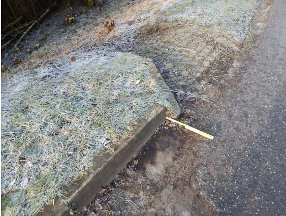
ASL_030_0_2022E_L-BORD HINTEN ANFAHRSCHADEN
