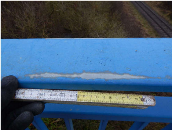
ASL_027_0_2025E_L-GEL VORNE BESCHICHTUNG BESCHÄDIGT
