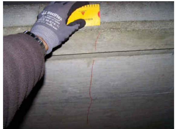
2131513_0_2009H_L-SCHUTZDACH UNTEN QUERRISS
