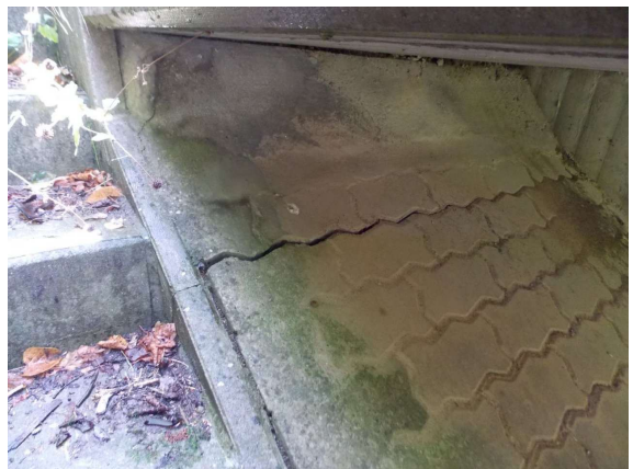
2131506_0_2013E_HINTEN LINKS TRAUFPFLASTER OFFENE FUGE
