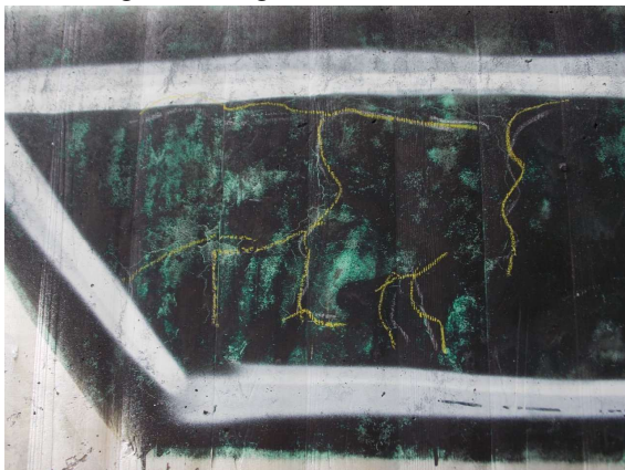
2131506_0_2013E_WIDERLAGER HINTEN NETZRISSE
