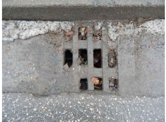
2131513_0_2025H_BRÜCKENABLAUF VORNE VERSCHMUTZT
