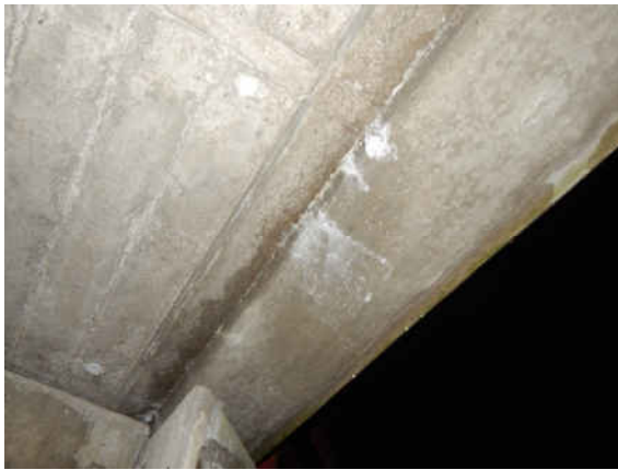
2131513_0_2025H_L-KRAGARM VORNE AUßEN AUSSINTERUNGEN
