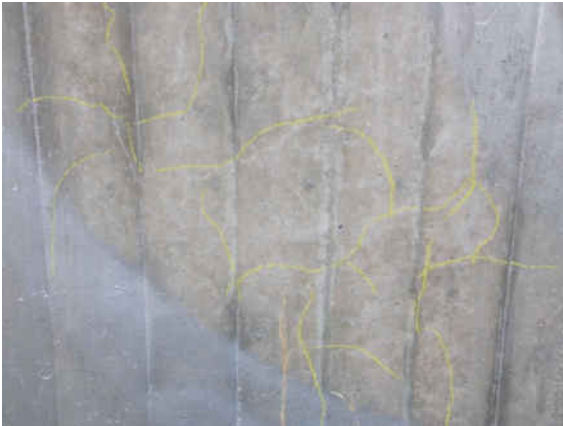
2131513_0_2013E_WL-H FLÜGEL LINKS NETZARTIGE RISSE
