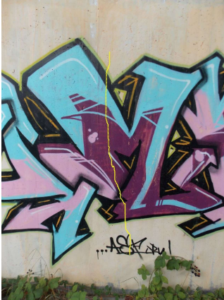
2131506_0_2013E_WIDERLAGER V GERISSEN
