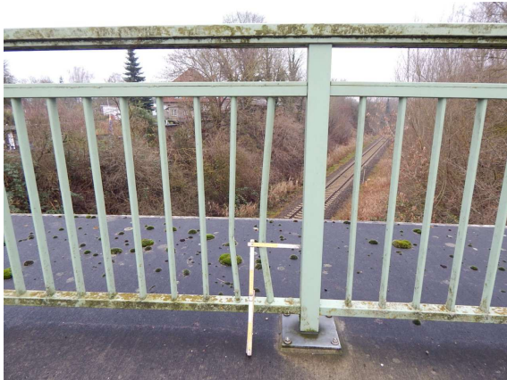
2131506_0_2019H_R-GELÄNDER VORNE ANPRALLSCHADEN
