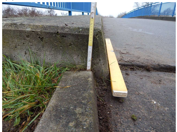
ASL_027_0_2025E_L-BORD VORNE BORDSTEIN ABGESACKT
