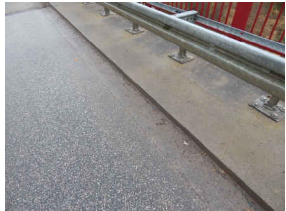
2131513_0_2025H_FAHRBAHN HINTEN RECHTS VERSÄNDUNGEN
