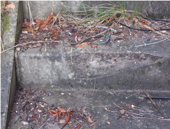
2131506_0_2013E_VORNE RECHTS TREPPE KANTENABPLATZUNG
