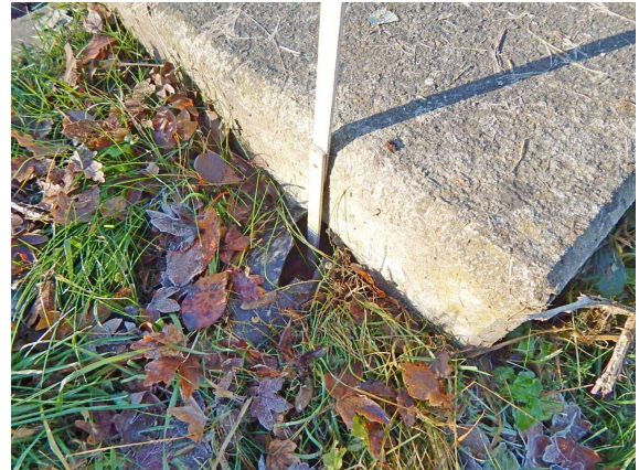
ASL_030_0_2025H_SCHUTZROHR VORNE RECHTS GEBROCHEN
