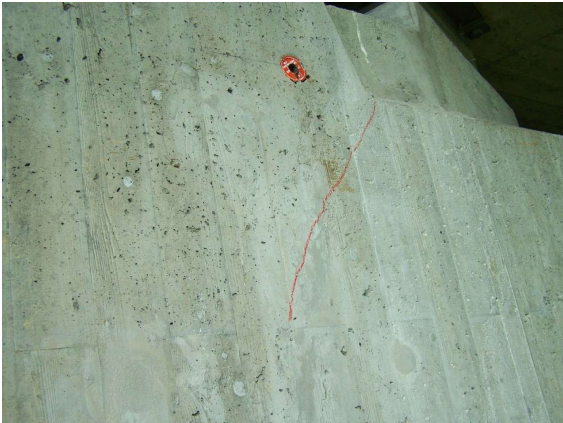
2131506_0_2009H_WL-V RECHTS GERISSEN
