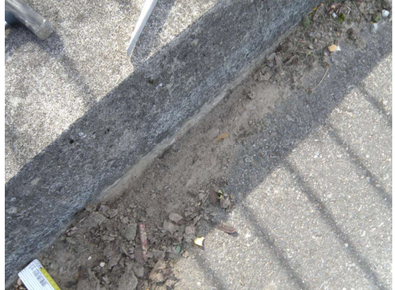
ASL_027_0_2016H_FAHRBAHN FUGE BELAG-BORD FEHLT IM FLÜGELBEREICH
