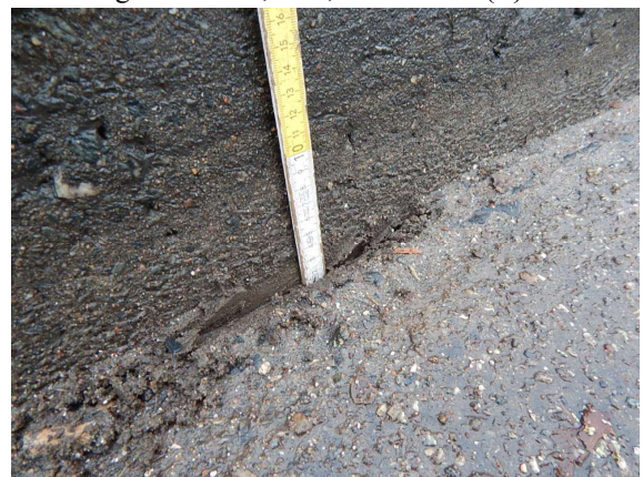
2131506_0_2019H_BELAG RECHTS FUGE HERAUSGEQUOLLEN
