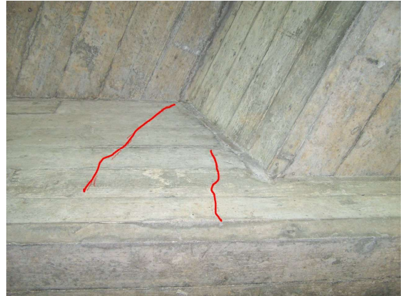
2131506_0_2009H_EQT-H RECHTS GERISSEN
