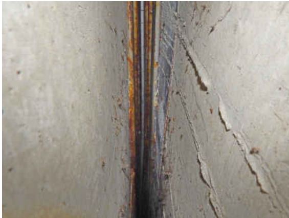
2131513_0_2025H_FÜK WL-H UNTERSEITE ANGEROSTET
