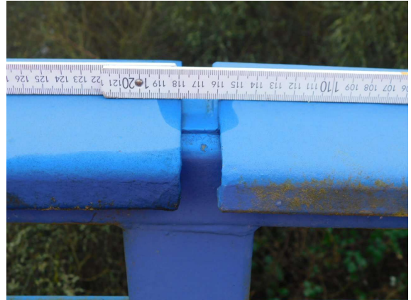
ASL_030_0_2017H_L-GEL HANDLAUF FUGENSTÜCK FEHLT
