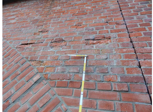
ASL_030_0_2022E_R-STW HINTEN ZIEGEL FROSTGESCHÄDITGT
