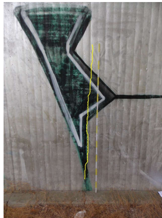
2131506_0_2013E_WIDERLAGER HINTEN GERISSEN
