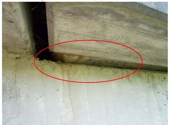
2131506_0_2009H_L-KRAGARM A-20 LINKS UNDICHTIGKEIT
