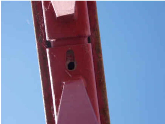
2131513_0_2013E_RECHTES GELÄNDER FEHLENDE SCHRAÜBE
