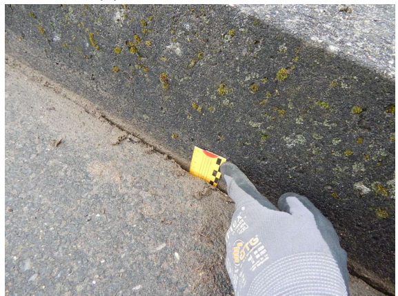
ASL_027_0_2025E_BELAG L-FUGE VERGUSS HERAUSGEQUOLLEN
