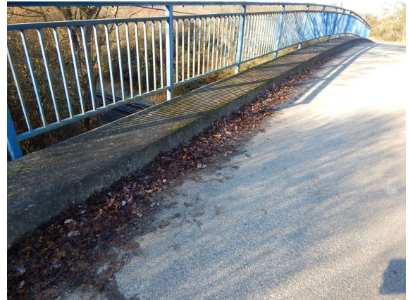
ASL_030_0_2025H_FAHRBAHN VORNE LINKS LAUBVERSCHMÜTZUNGEN
