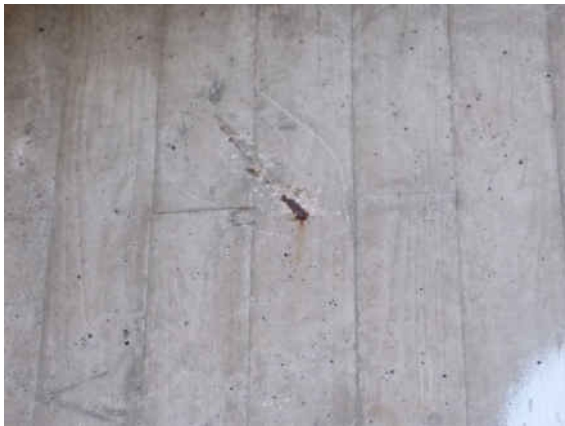
2131513_0_2013E_WL-H FLÜGEL LINKS FREILIEGENDE BEWEHRUNG
