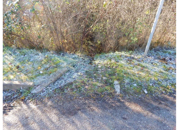
ASL_030_0_2025H_L-KASKADE WL-H VERSCHMUTZT EINGEWACHSEN
