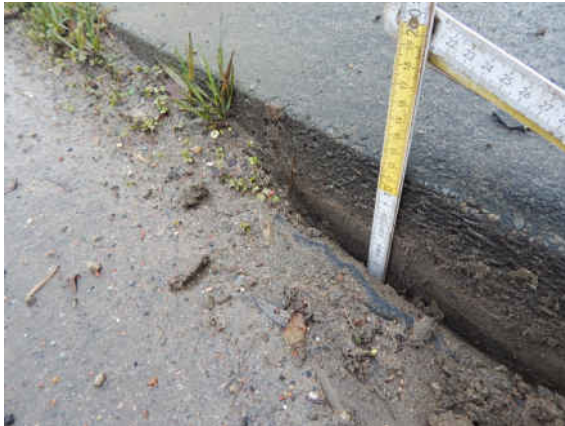
2131513_0_2019H_BELAG L-FUGE HERAUSGEQUOLLEN
