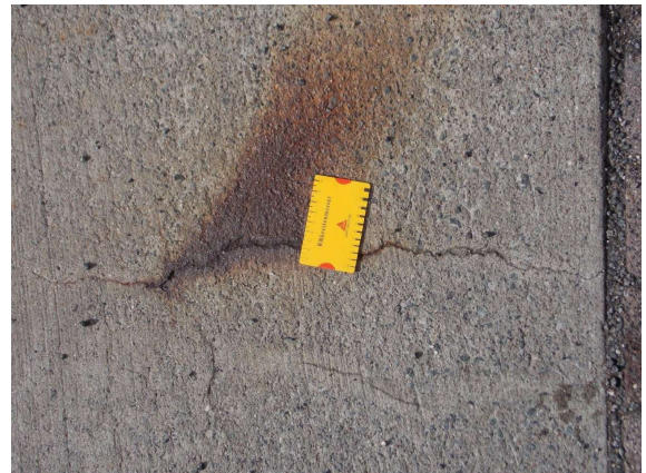
2131506_0_2013E_LINKE KAPPE K-WAND VORNE LÄNGSRISS
