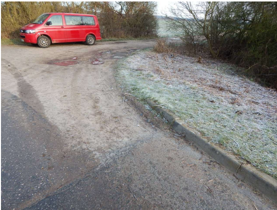
ASL_030_0_2022E_R-BORD HINTEN ANFAHRSCHADEN
