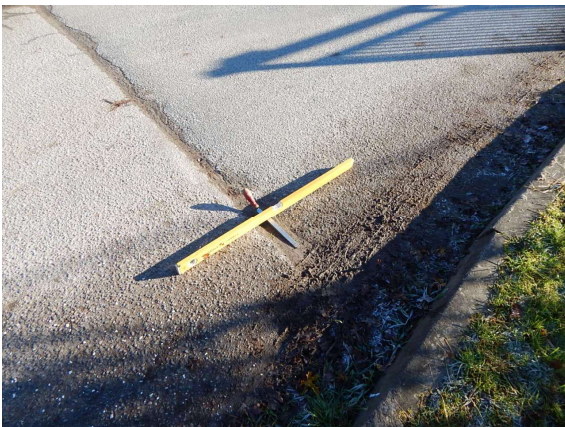
ASL_030_0_2025H_FAHRBAHN HINTEN VERSACKUNGEN MIT RISSIGER FUGE
