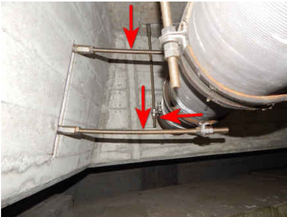
2131513_0_2025H_ENW-LEITUNG VORNE UNTER SPANNUNG
