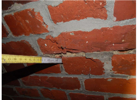
ASL_030_0_2025H_GEWÖLBE VORNE RECHTS FUGEN BRÜCHIG
