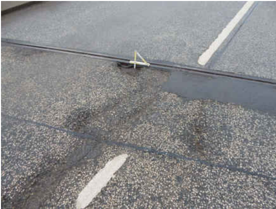
2131513_0_2025H_BELAG HINTEN RISSIG BRÜCHIG
