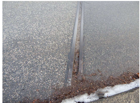
2131506_0_2025H_FÜK VORNE RECHTS VERSCHMUTZT
