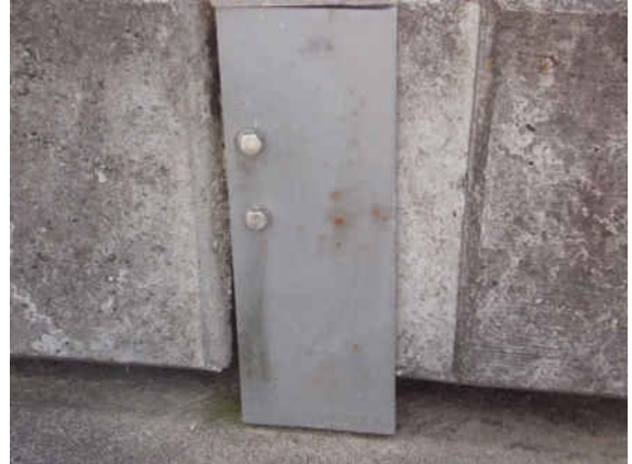
2131513_0_2013E_FÜK A-10 ABDECKBLECH ROSTSTELLEN
