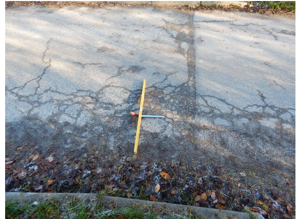
ASL_030_0_2025H_BELAG VORNE LINKS RISSIG UND VERSACKT
