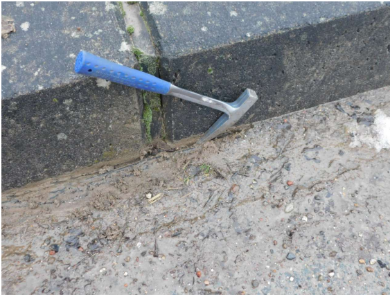
ASL_030_0_2017H_BELAG HINTEN RECHTS FUGE HERAUSGÉQUOLLEN
