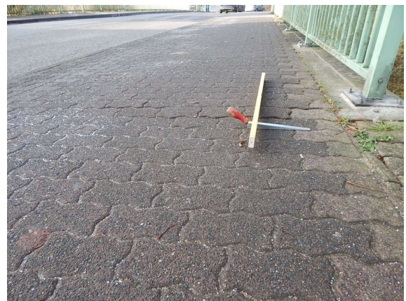
2131506_0_2025H_L-WEG HINTEN VERSACKUNGEN
