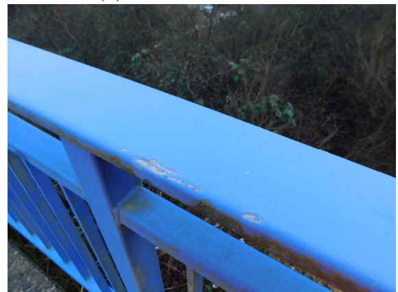
ASL_030_0_2017H_L-GEL HINTEN BESCHICHTUNG BESCHÄDIGT
