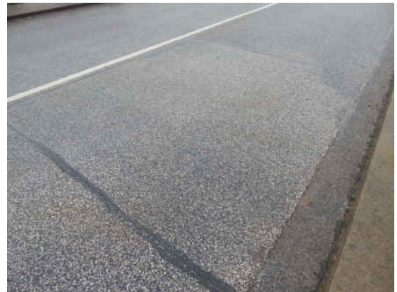
2131513_0_2025H_BELAG HINTEN LINKS INSTANDSETZUNG GERISSEN
