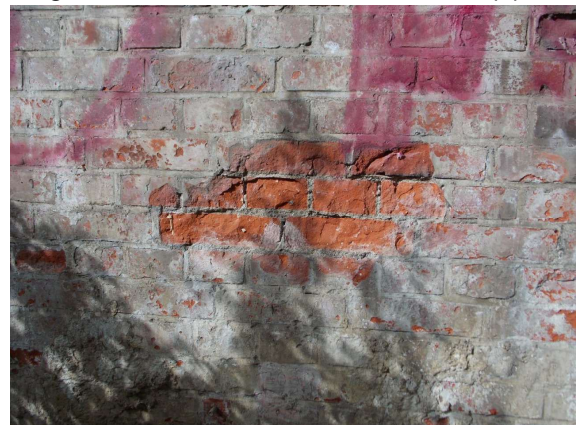
ASL_030_0_2013E_WL-V ABPLATZUNGEN FROSTSCHADEN
