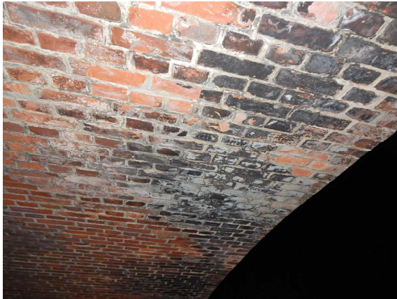
ASL_030_0_2017H_GEWÖLBEUNTERSEITE RECHTS MITTIG VERRUßT
