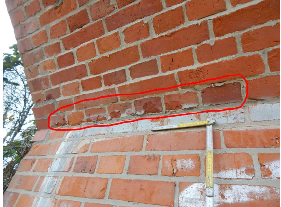
ASL_027_0_2019E_GEWÖLBE VORNE RECHTS ZIEGEL HOHLKLINGEND
