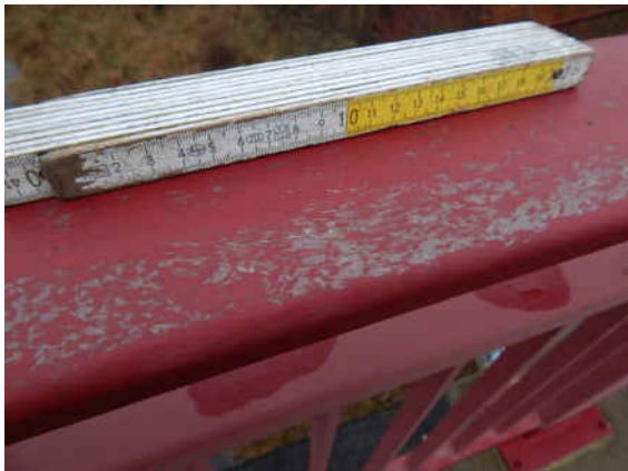
2131513_0_2019H_L-GEL DECKBESCHICHTUNG UNVOLLSTÄNDIG
