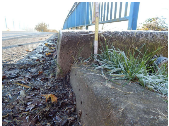
ASL_030_0_2025H_L-BORD HINTEN ABGESACKT
