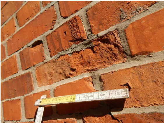
ASL_027_0_2019E_GEWÖLBE HINTEN RECHTS ZIEGEL BRÜCHIG
