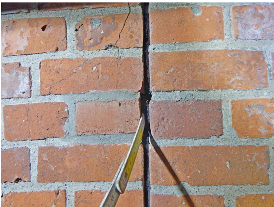
ASL_030_0_2025H_L-STW H-FUGE KOMPRIBAND VERWITTERT
