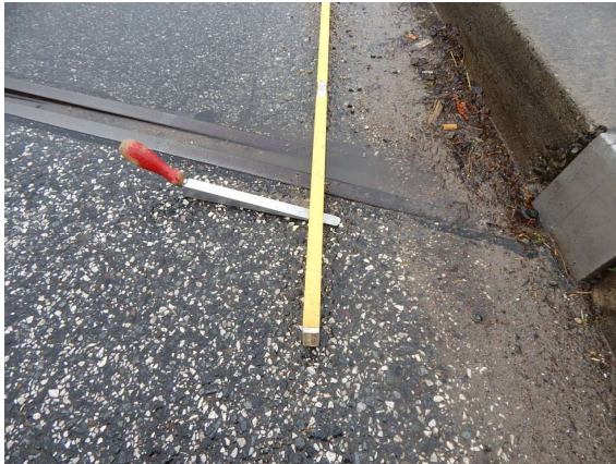
2131506_0_2022E_FAHRBAHNBELAG HINTEN LINKS ZU TIEF
