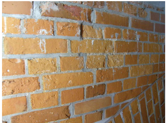
ASL_027_0_2016H_STIRNWAND RECHTS VORNE- STEINE VERWITTERT UND ABGEPLATZT
