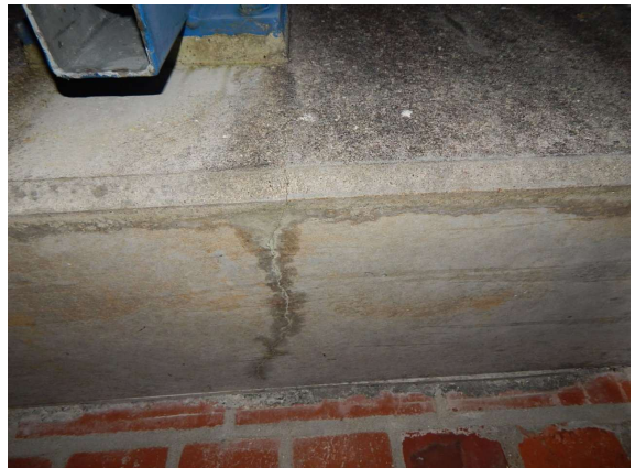
ASL_030_0_2025H_L-GESIMS HINTEN QUERRISS MIT AUSSINTERUNGEN
