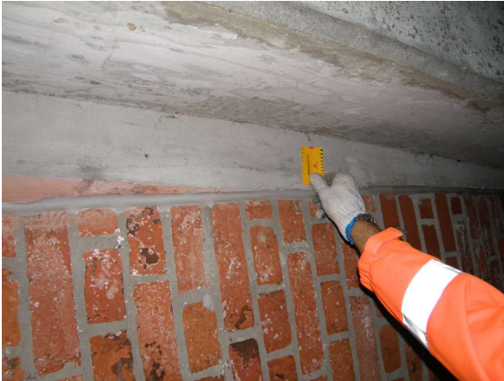
ASL_027_0_2016H_STIRNWAND RECHTS OBEN - WAAGERECHTER RISS
