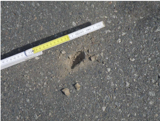
ASL_027_0_2016H_BELAG HINTEN AUSBRUCH
