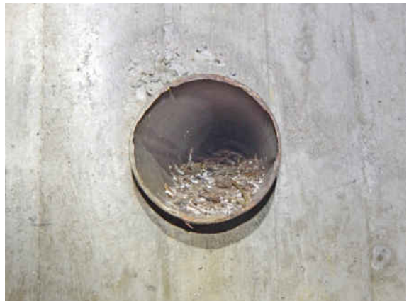
2131513_0_2019H_A-BANK WL-V ENTW-ROHR VERSCHMUTZT
