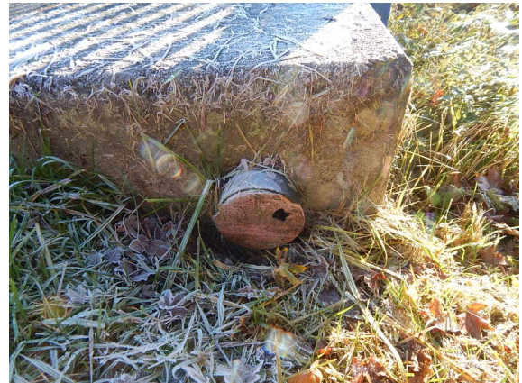
ASL_030_0_2025H_SCHUTZROHR L-KAPPE HINTEN DECKEL GEBROCHEN
