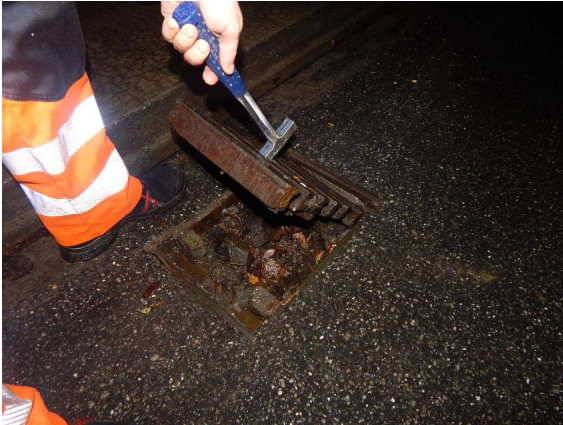
2131506_0_2019H_ABLAUF VORNE LINKS SCHARNIER GEBROCHEN
