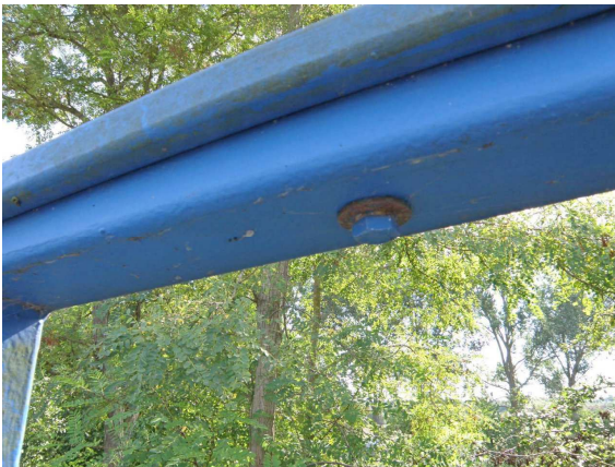
ASL_027_0_2016H_GELÄNDER HINTEN RECHTS - UNTERLEGSSCHEIBE ANGEROSTET
