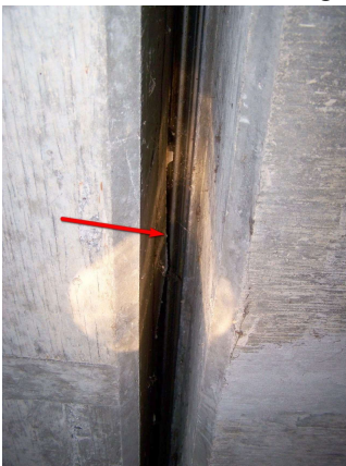
2131506_0_2009H_K-WAND-V KONSOLE BETONIERFEHLER
