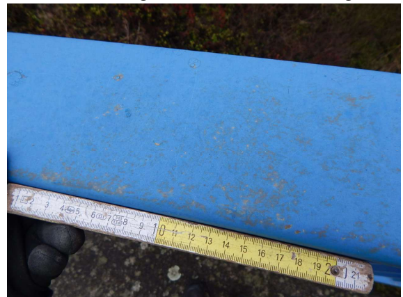
ASL_027_0_2025E_L-GEL VORNE DECKBESCHICHTUNG ABGEWITTERT
