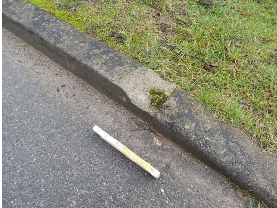
ASL_027_0_2022H_R-BORD VORNE BORDSTEIN MIT ABPLATZUNG
