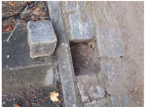
2131506_0_2013E_VORNE RECHTS TRAUFPFLASTER LOSE STEINE
