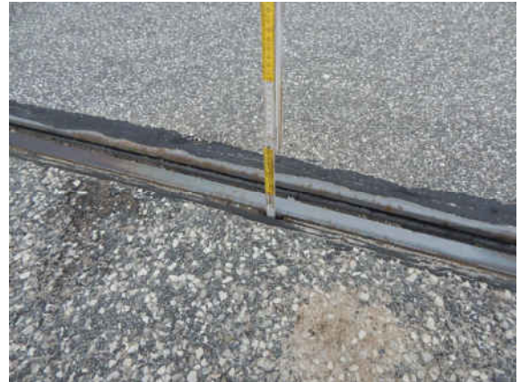
2131513_0_2022E_BELAG VORNE FUGE AN FÜK ABGELÖST
