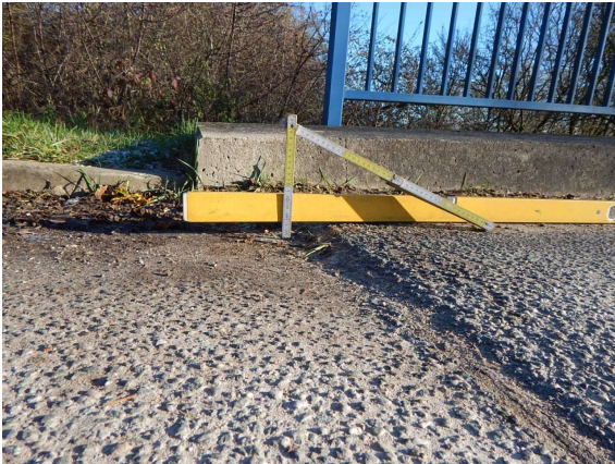
ASL_030_0_2025H_FAHRBAHN HINTEN RECHTS ABSACKUNGEN
