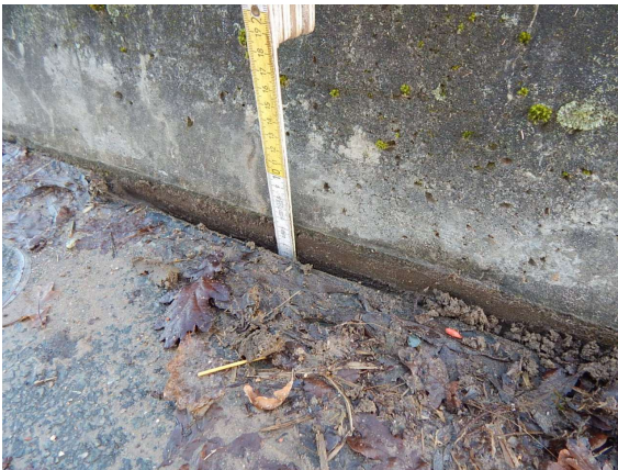
ASL_032_0_2019H_BELAG L-FUGE HERAUSGEQUOLLEN
