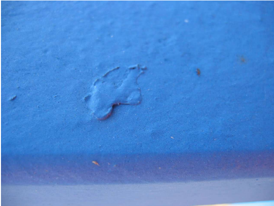
ASL_032_0_2009H_GELÄNDER BESCHICHTUNG ABKREIDEND
