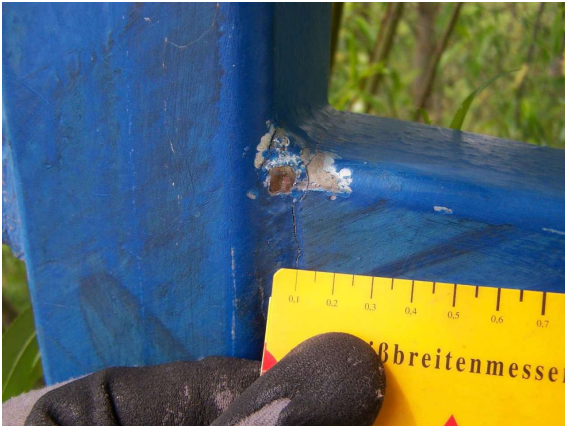
ASL_032_0_2013H_R-GEL VORNE SCHWEIßNAHT GERISSEN
