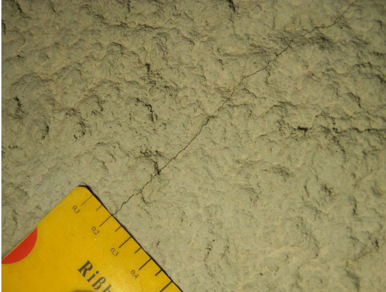
ASL_032_0_2013H_L-STIRNWAND VORNE SPRITZBETON GERISSEN
