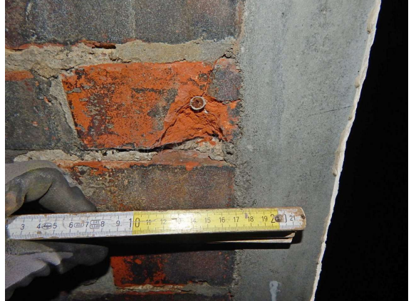
ASL_032_0_2025H_GEWÖLBE VORNE LINKS ZIEGEL BRÜCHIG
