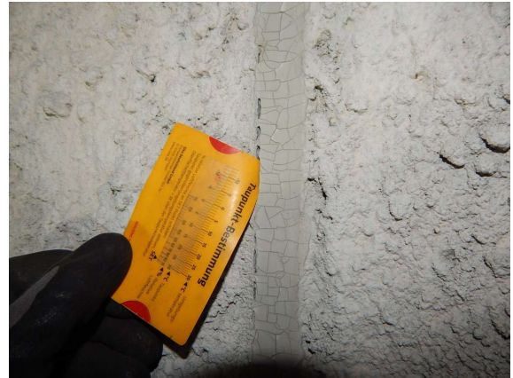
ASL_032_0_2025H_L-GESIMS VORNE FUGE ABGELÖST
