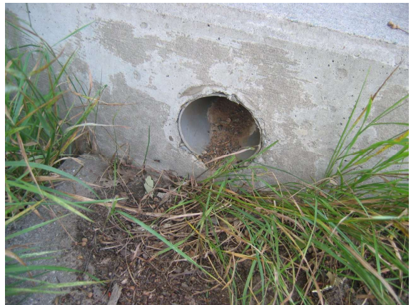
ASL_032_0_2009H_R-KAPPE HINTEN SCHUTZROHR ABDECKUNG FEHLT
