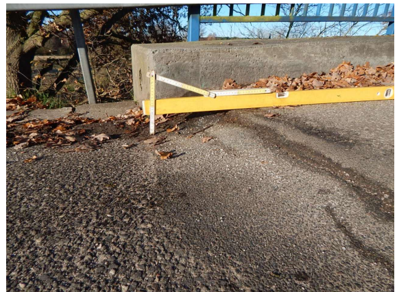
ASL_032_0_2025H_FAHRBAHN HINTEN RECHTS ABGESACKT
