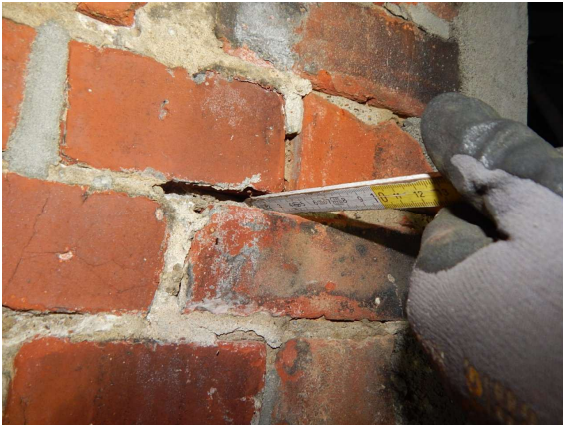
ASL_032_0_2025H_GEWÖLBE VORNE LINKS FUGEN BRÜCHIG
