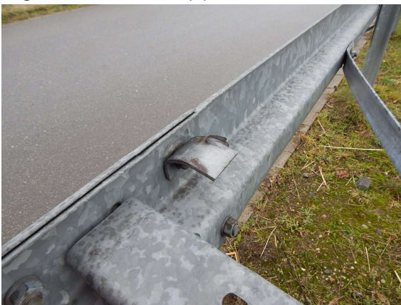
ASL_032_0_2016E_R-ESP HINTEN LEITPFOSTEN ABGERISSEN
