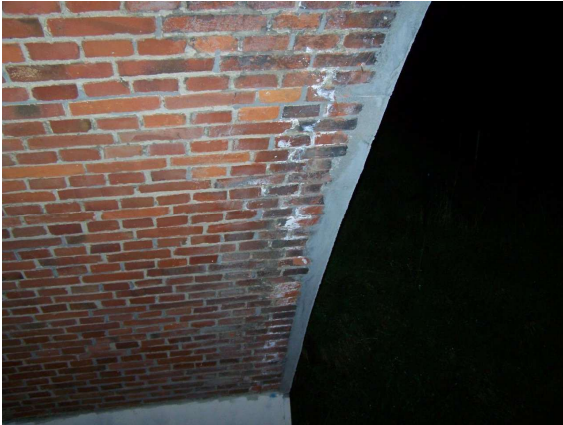
ASL_032_0_2013H_GEWÖLBE VORNE LINKS AUSBLÜHUNGEN
