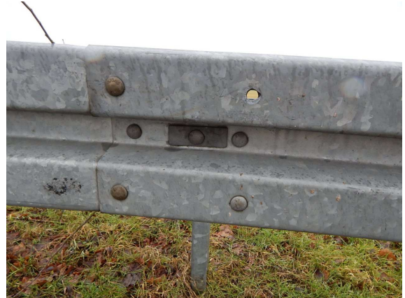
ASL_032_0_2016E_V-R-ESP BOLZEN FEHLT
