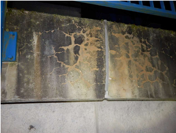
ASL_032_0_2019H_L-GESIMS VORNE NETZRISSE
