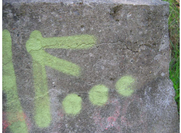
ASL_032_0_2009H_BETONSOCKEL WL-H RECHTS GERISSEN
