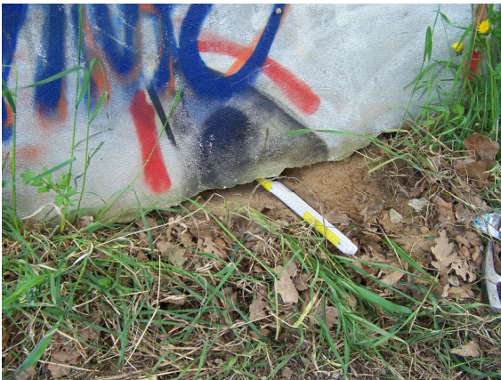
ASL_032_0_2013H_BETONSOCKEL WL-H UNTERHÖHLT
