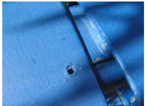
ASL_032_0_2009H_R-GEL HANDLAUF FEHLBOHRUNG
