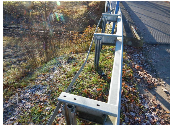
ASL_032_0_2025H_L-EDSP VORNE SPANNBAND VERBOGEN
