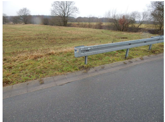
ASL_032_0_2016E_H-R-ESP ABSENKUNG FEHLT
