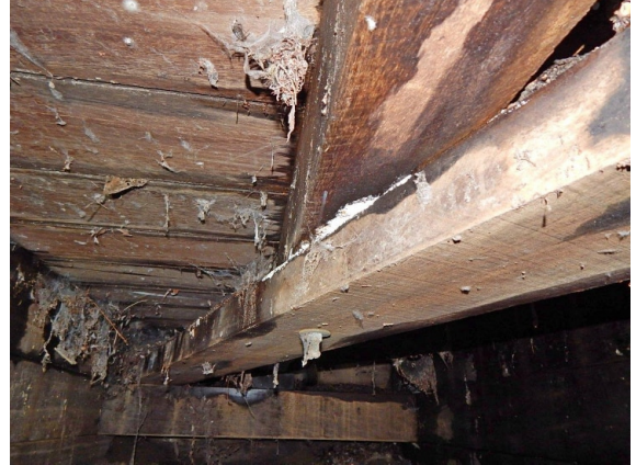
ASL_002_0_2015H_MITTELHOLZ VORNE PILZBEFALL
