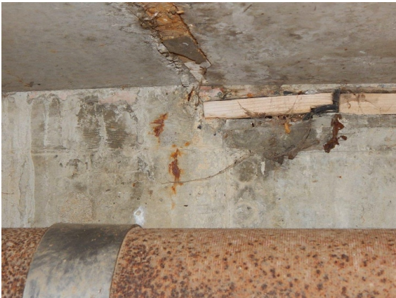
2131501_0_2020H_L-FL WL-H MITTIG OBEN ROSTFAHNEN
