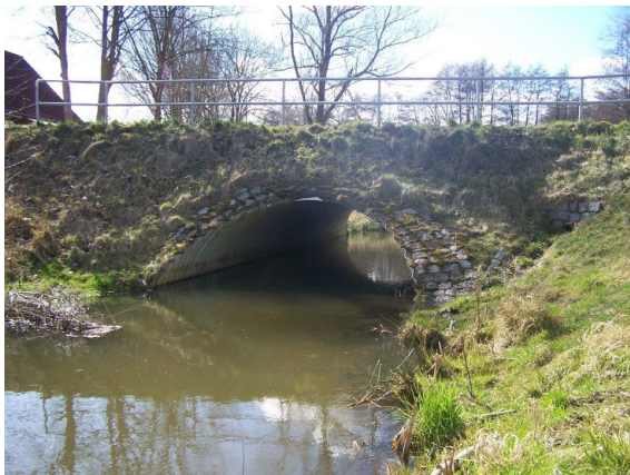
ASL_029_0_2015H_GELÄNDER NICHT REGELGERECHT
