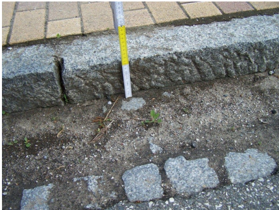
ASL_029_0_2012E_L-SCHRAMMBORD ZU NIEDRIG
