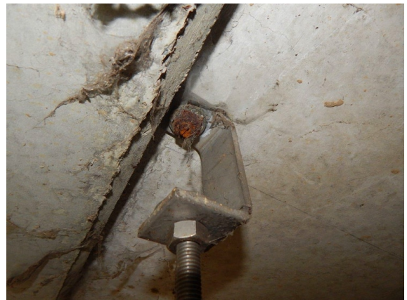
2131501_0_2020H_LEITUNGEN LINKS VORNE SCHRAUBEN RÖSTIG
