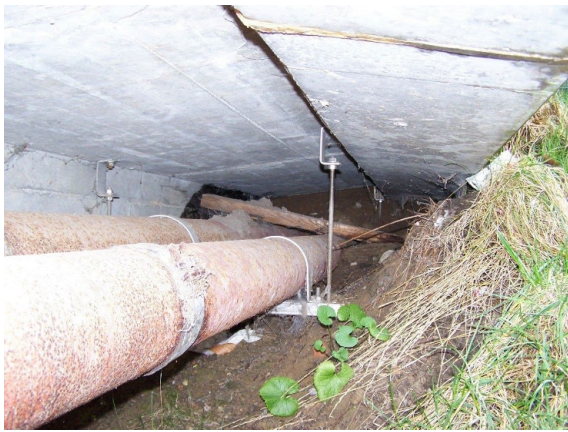
2131501_0_2009H_V-L-BÖSCH NICHT AUSREICHEND
