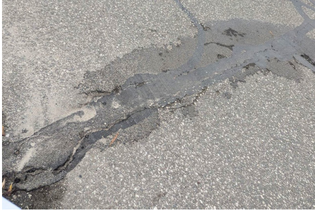
2024E_BELAG HINTEN RISS INSTANDSETZUNG SCHADHAFT
