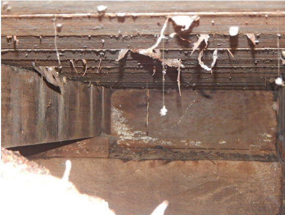
ASL_002_0_2020E_K-WAND WL-H PILZBEFALL
