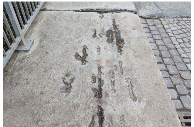
2024E_L-KAPPE VORNE FREILIEGENDE KORRODIERTE BEWEHRUNG
