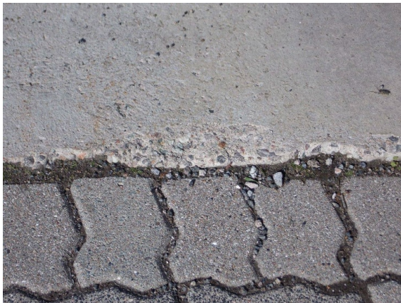
2131501_0_2013E_L-KAPPE HINTEN KANTE BRÜCHIG
