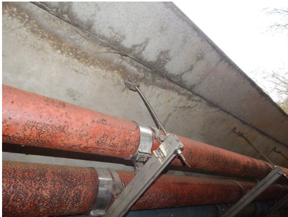
2131501_0_2020H_R-GESIMS UNTEN AUSSINTERUNGEN
