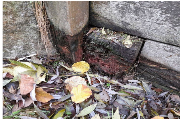
2024H_QT VORNE RECHTS VERFAULT
