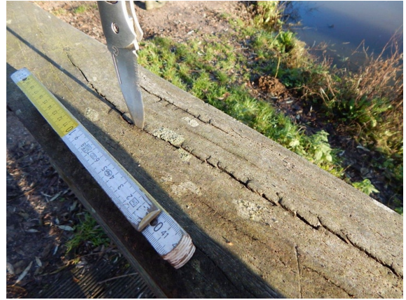
ASL_002_0_2015H_R-GEL HANDLAUF OBERSEITE GERISSEN
