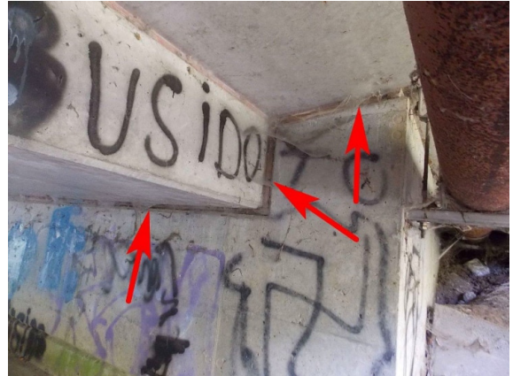
2131501_0_2013E_WL-V SCHALUNG NICHT ENTFERNT
