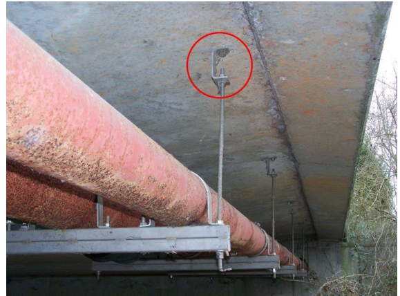
2131501_0_2009H_R-LEITUNGEN ABHÄNGUNG MANGELHAFT
