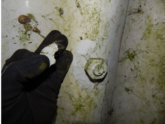
ASL_029_0_2015H_ROHR INNEN RECHTS BESCHICHTUNG ABGEBLÄTERT
