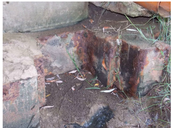
2131501_0_2013E_WL-V LINKS SPUNDWAND KORRODIERT BLATTROST
