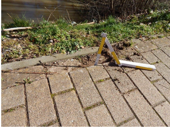
ASL_029_0_2020E_L-WEG MITTIG AUßEN PFLASTER ABGESACKT
