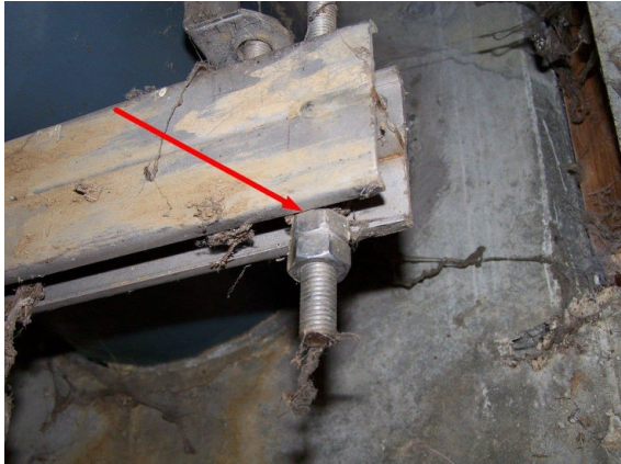
2131501_0_2009H_R-LEITUNGEN KONSOLE-1 LINKS U-SCHEIBE FEHLT
