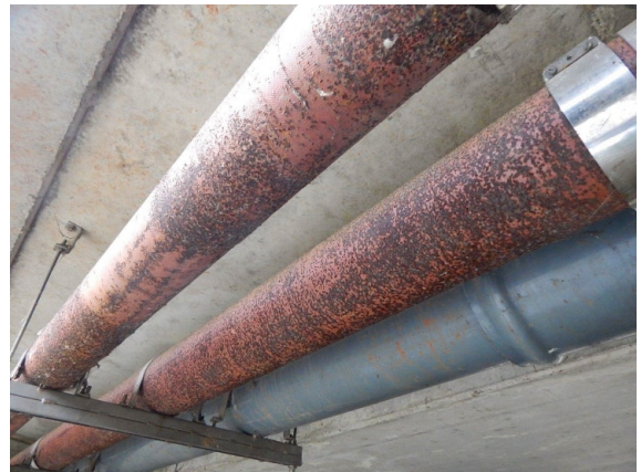
2131501_0_2020H_LEITUNGEN RECHTS UNTERROSTUNGEN
