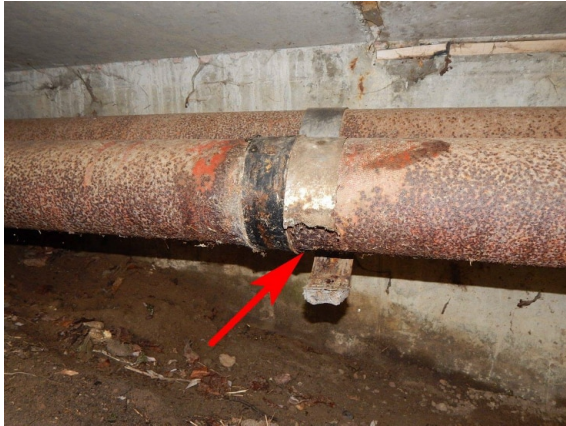
2131501_0_2020H_SCHUTZROHR LINKS HINTEN SCHELLE DURCHGEROSTET
