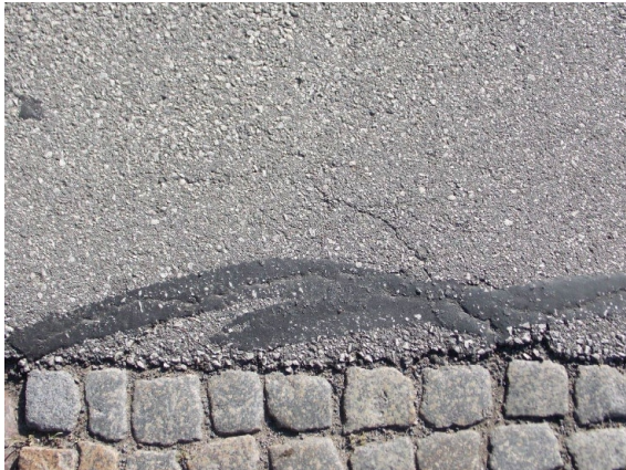
2131501_0_2013E_BELAG RISS HINTER INSTANDSETZUNG
