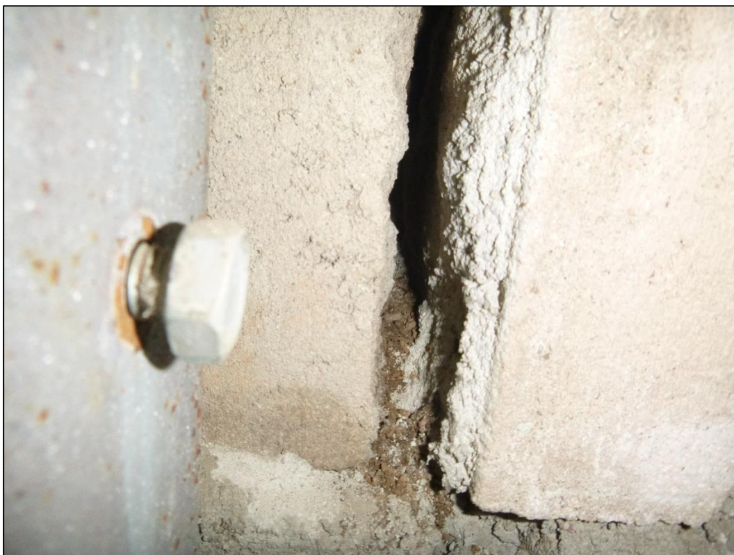
Abbildung 7: Spalten mit dahinter liegenden Hohlräumen und größeren Mengen an Fledermauskot im Mauerwerk vom Gebäude Nr. 11
