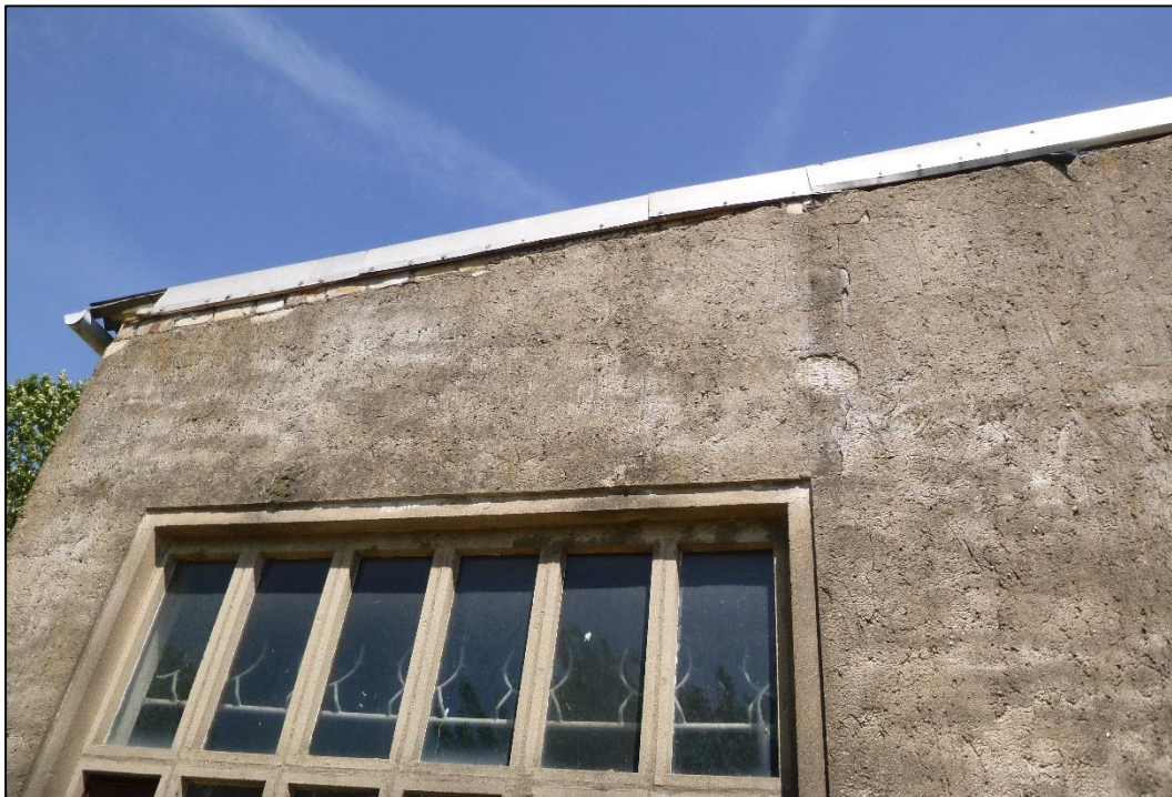
Abbildung 2: Ansicht der Blechverkleidung an der ein Einflug einer Zwergfledermaus beobachtet wurde
