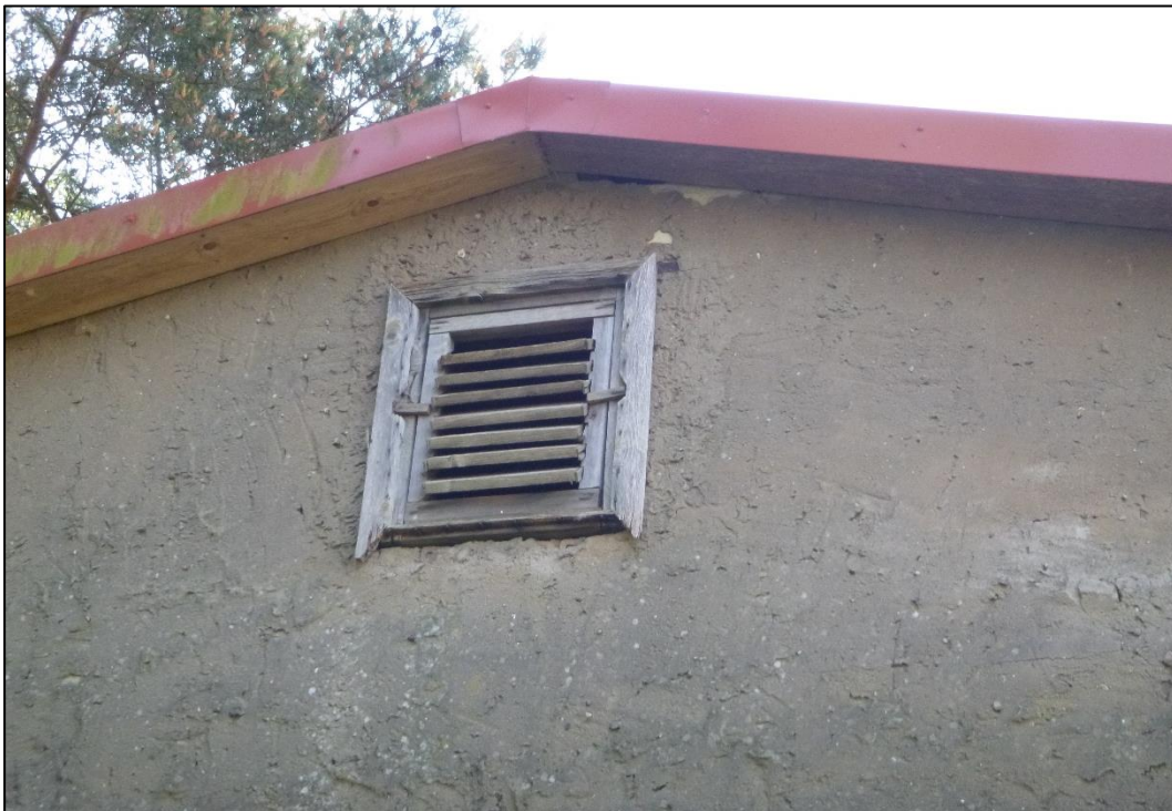
Abbildung 9: Beispielansicht eines Lüftungsgitters als Einschupfmöglichkeit in den Dachbereich
