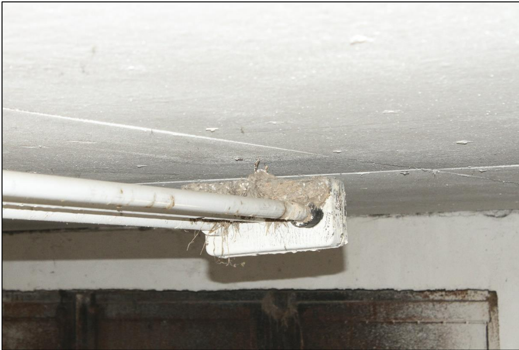
Abbildung 10: Ansicht der zwei Rauchschnalbenneſter auf einer Lampe im Heizungsraum von Gebäude Nr. 6
