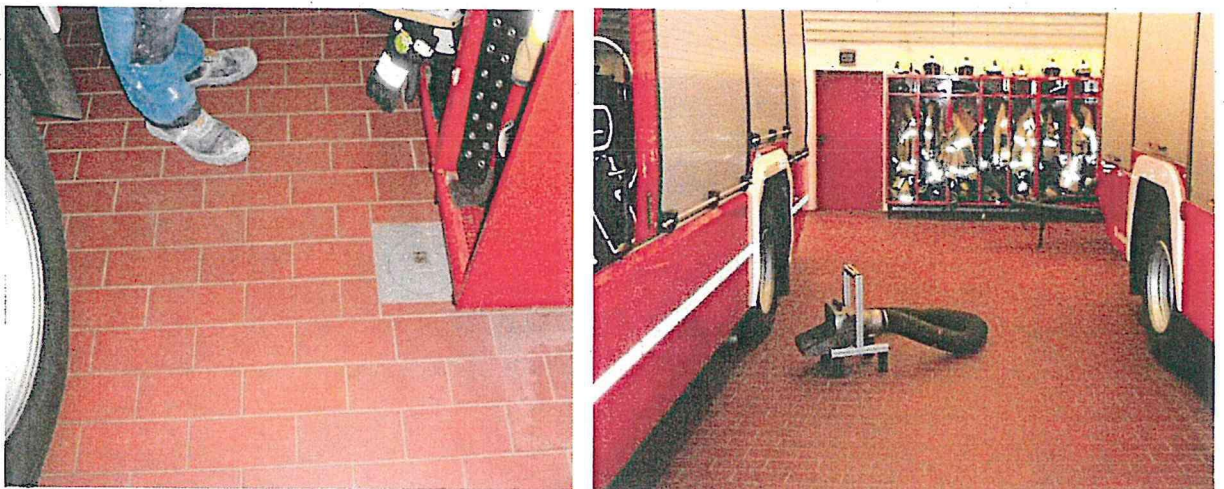
Fehlende bzw. nicht nutzbare Abgasabsaugung, Abgasabsaugung im Verkehrsweg
