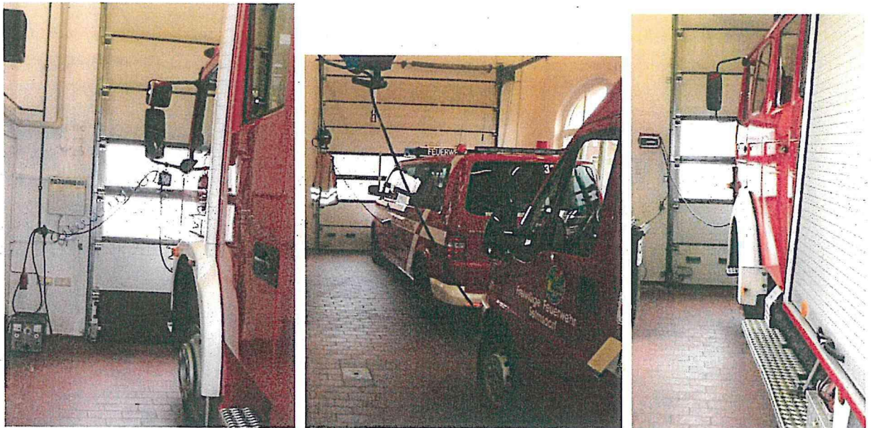
Druckluftversorgung und Ladekabel in Verkehrswegen
