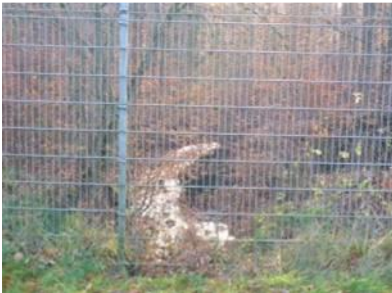
Abbildung 26: Einleitstelle gereinigtes Wasser
